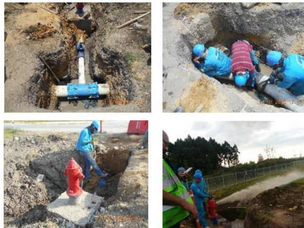
Figura 7 Actividades sistema contra incendio / Fuente: Informe Final Contrato de Interventoría N° 17000995 H3 DE 2017 31/01/2019
