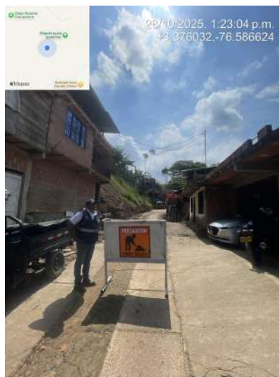
Fotografía 20. Evidencia de señalización en el sector Las Veraneras el día 28 de octubre de 2025
