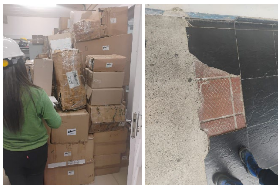
Apilamiento de cajas con riesgo de caída (ambiente de mantenimiento de vehículos) / Pisos en mal estado pasillo principal.
