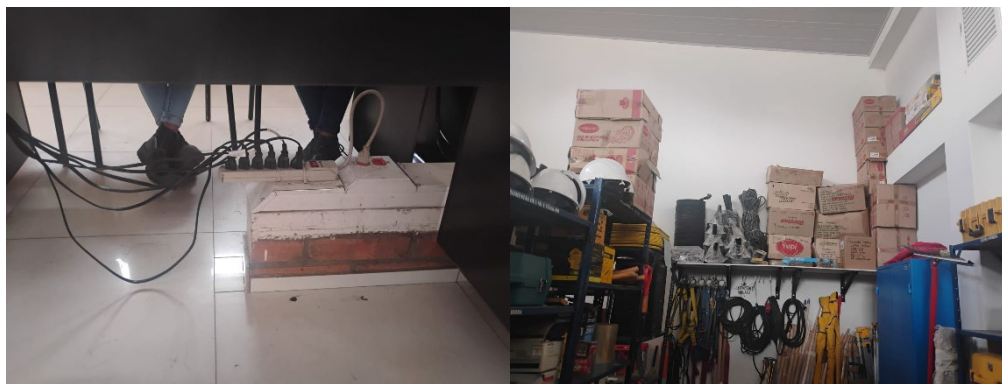
Extensiones sobrecargadas (ambiente sistemas) / Apilamiento de cajas con riesgo de caída (ambiente construcción)
