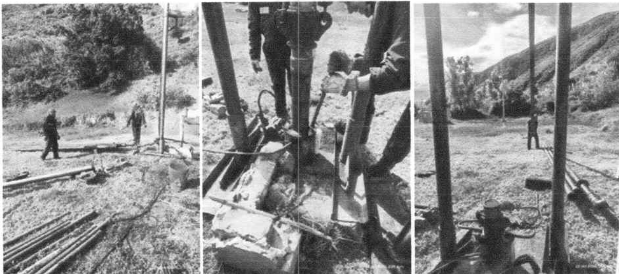
Figura 3. Desconexión árbol del pozo
