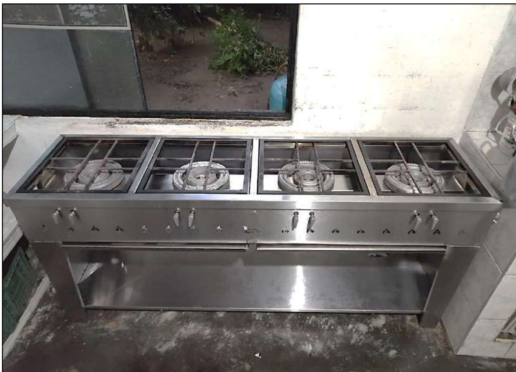
Imagen 129. Estufa industrial de 4 puestos nueva (instalada).
