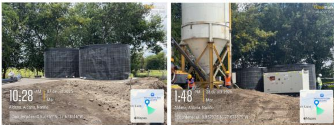
Figura 42 Tanques de almacenamiento - Planta concretera
