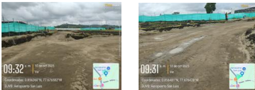
Figura 14 Espesores variados desniveles y ondulación, huecos y empozamientos Vía LT-03
