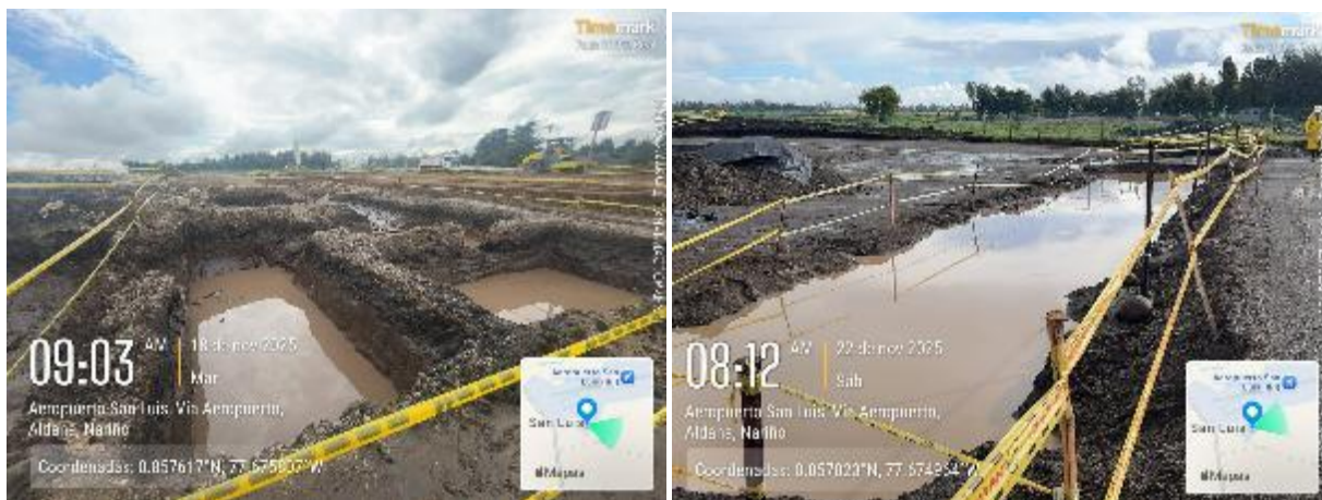
Figura 33 Almacenamiento de agua lluvia
