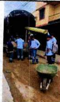
TURBOCAMIÓN SYQ 747 - DESCARGANDO PERSONAL Y MATERIALES - BARRIO MURILLO TORO
