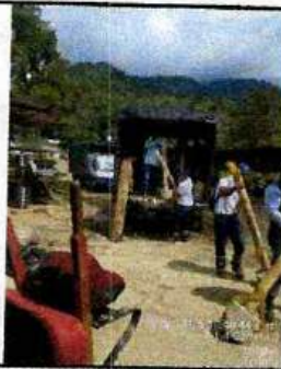
TURBOCAMIÓN TMZ 690 - DESCARGANDO PERSONAL - PLANTA IBAL BARRIO LA POLA
