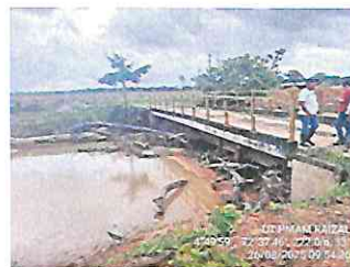
Deterioro de la infraestructura vial rural por escorrentías contaminadas y maquinaria agrícola en el Caño el Güira
