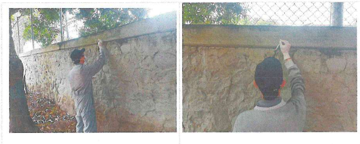
Zonas que se evidenciaron con comején fueron intervenidas.
