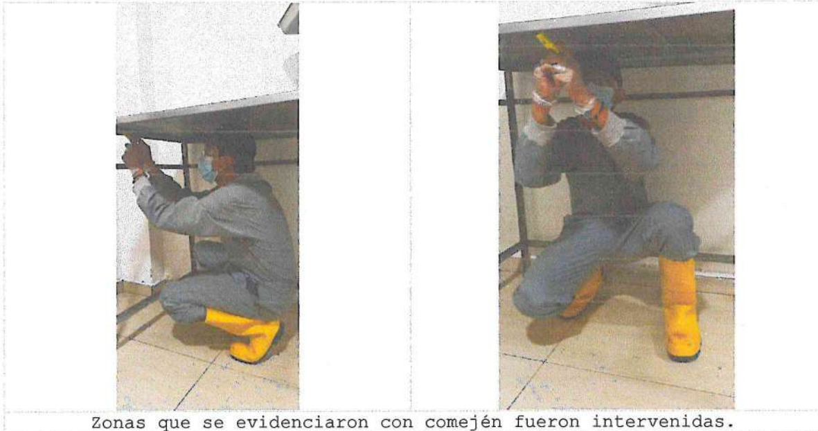
Zonas que se evidenciaron con comején fueron intervenidas.
