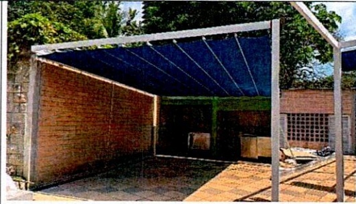
ESTRUCTURA METALICA PARA PERGOLA
