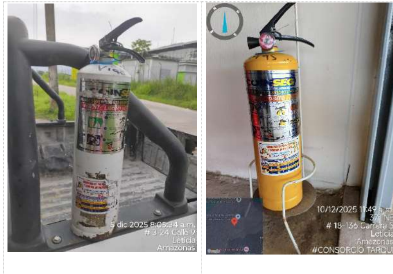
Registro Fotográfico. Inspección de Extintor
