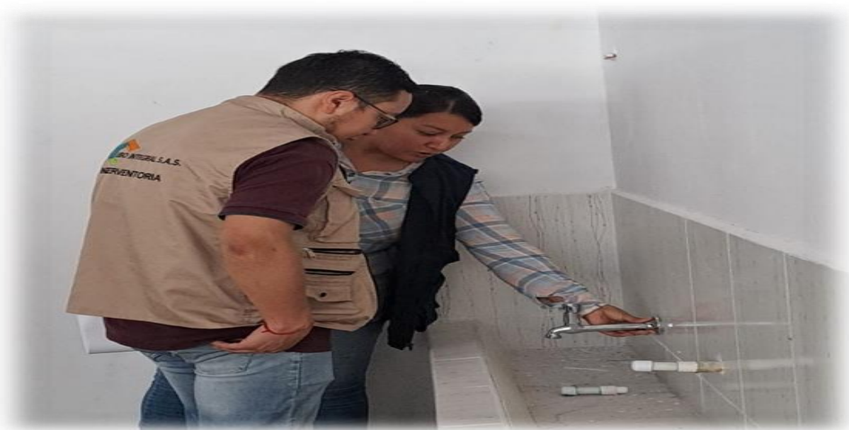
Detección de salida para punto hidráulico en mal estado, aplicar acciones correctivas reemplazo de grifería
