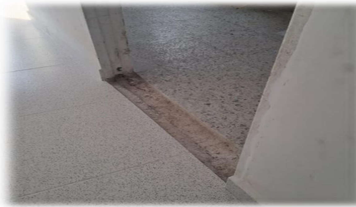
Detección boca puerta en estado de deterioro, aplicar acciones correctivas
