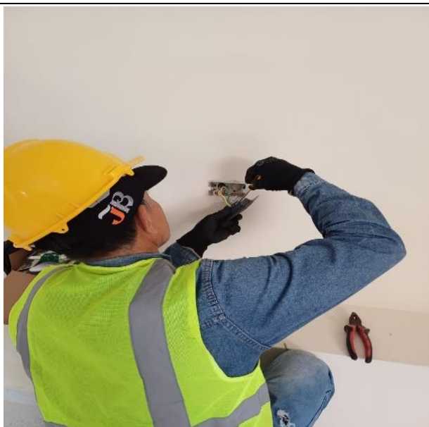
Desmonte de interruptores existentes en mal estado.
