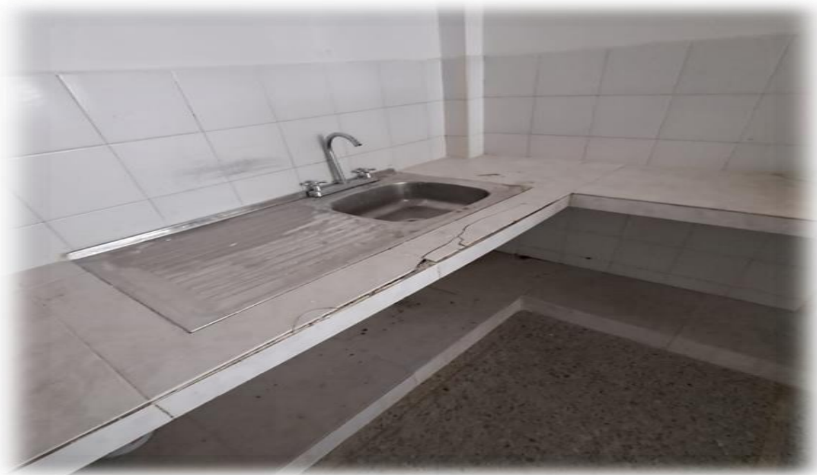
Detección de enchape en mal estado, aplicar acciones correctivas
