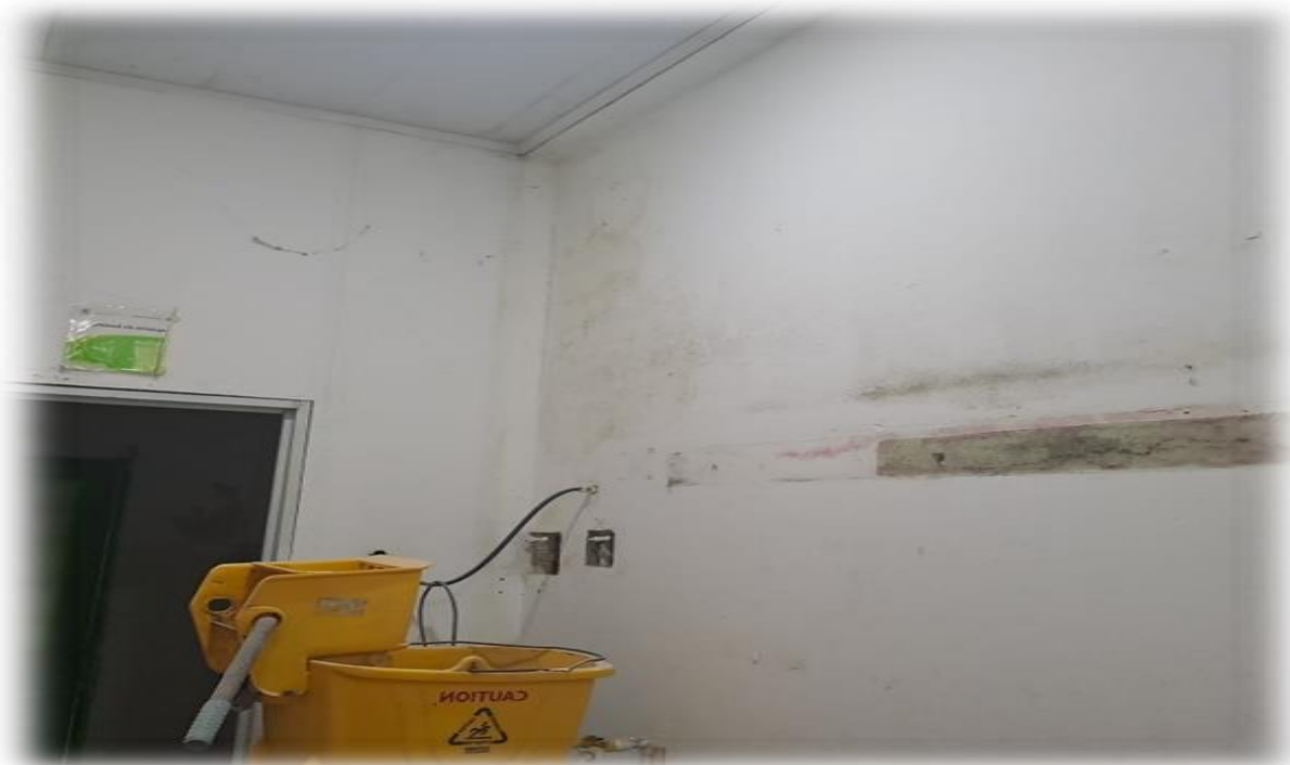
Detección de humedad, aplicar acciones correctivas con de interruptores en mal estado, aplicar acciones correctivas
