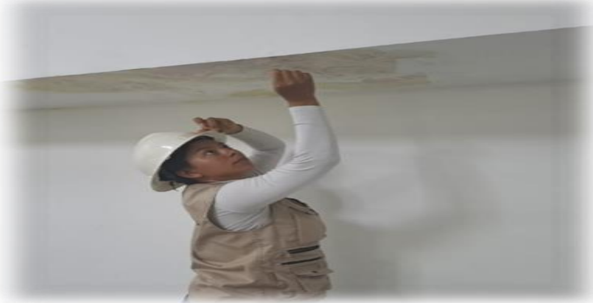
Detección de humedad, aplicar acciones correctivas con de interruptores en mal estado, aplicar acciones correctivas
