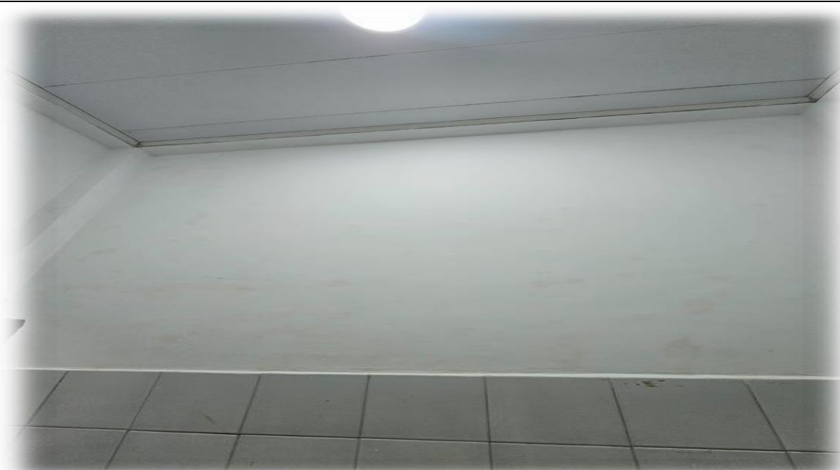
Se debe realizar verificación de causa de humedad y tomar acciones correctivas zona lavadero
