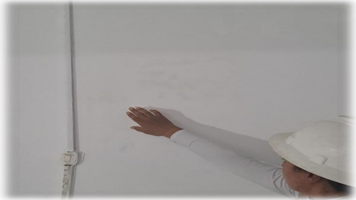
Detecciones de humedad, aplicar acciones correctivas
