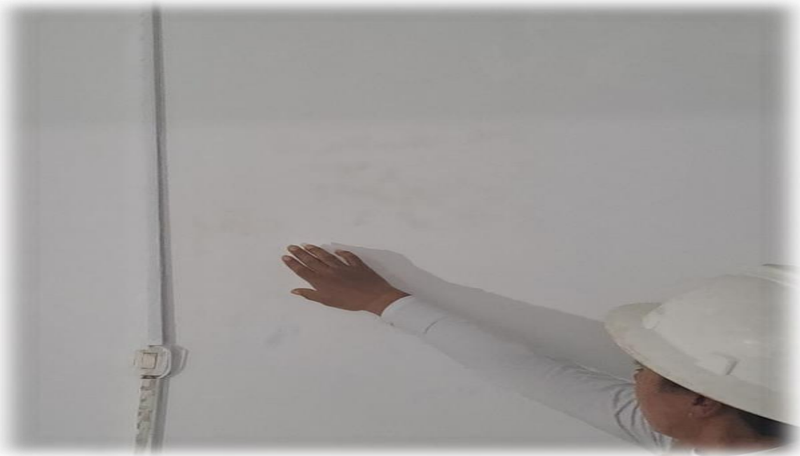
Detecciones de humedad, aplicar acciones correctivas
