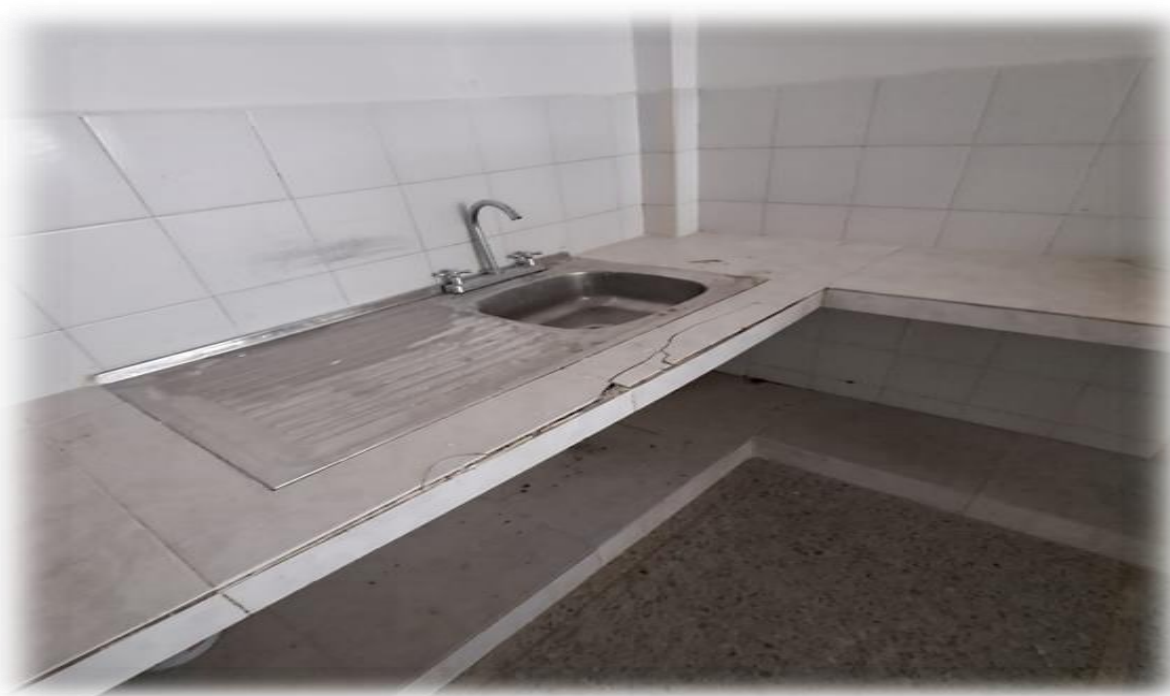
Detección de enchape en mal estado, aplicar acciones correctivas
