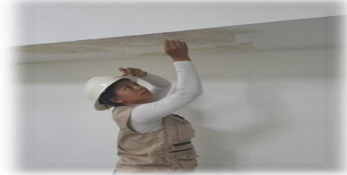
Detección de humedad, aplicar acciones correctivas con de interruptores en mal estado, aplicar acciones correctivas
