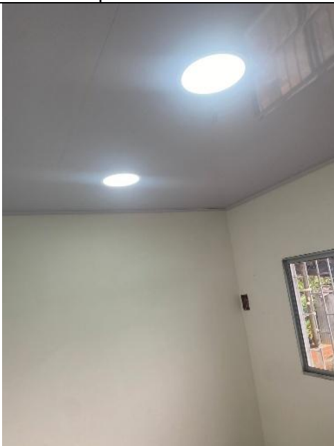
Instalación de lámparas
