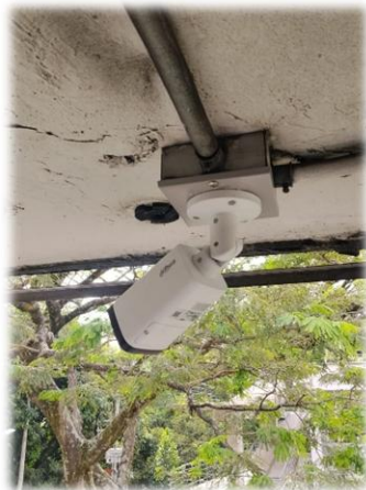
Cámara en Rack 2 Exterior
