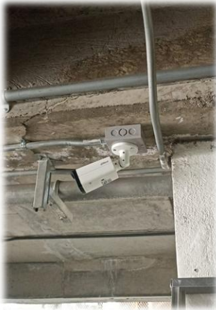
Cámara en Rampa Parqueadero Bloque C
