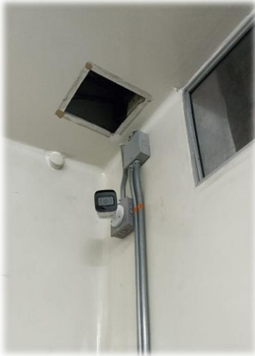
Cámara en Economato Fundacional
