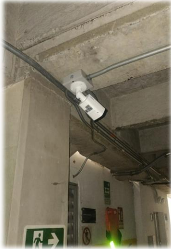
Cámara 2 en Sótano Bloque C
