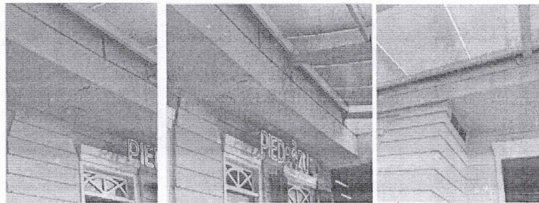
Fig.3-4-5 Grietas losa superior Piedra Azul
