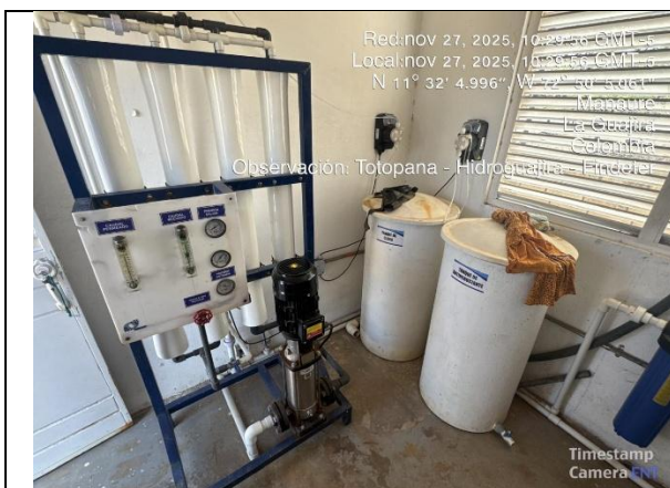
Fotografía 1. Planta de osmosis en la comunidad de Totopana.
