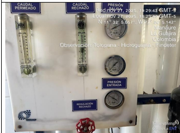
Fotografía 3. Osmosis inversa en la comunidad de Totopana.
