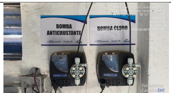
Fotografía 2. Dosificadoras de cloro y antincrustante en funcionamiento en la comunidad de San Felipe.
