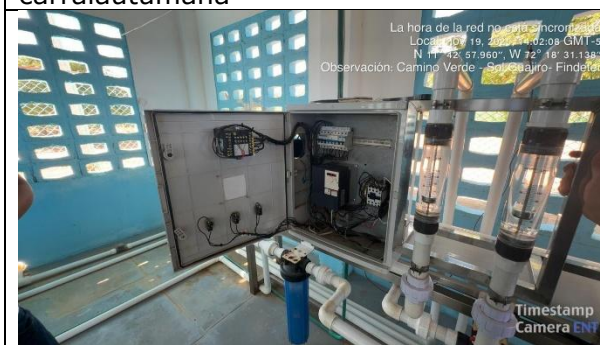
Fotografía 5. Revisión de variador en sistema de plotabilización en la comunidad de Camino Verde.
