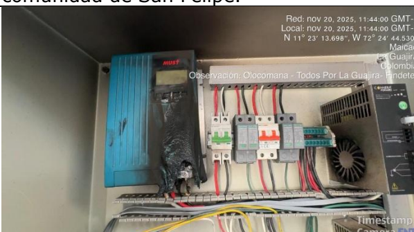
Fotografía 4. Sistema eléctrico de la comunidad de Olocomana quemados.
