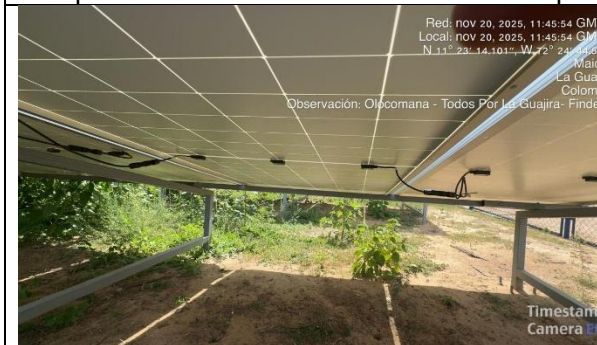
Fotografía 5. Verificación de las especificaciones de los paneles solares en la comunidad de Olocomana.
