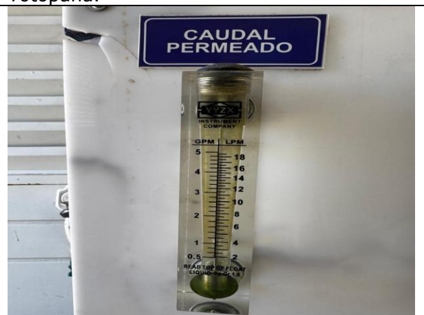
Fotografía 4. Caudal permeado sin función en la osmosis de la comunidad de Totopana.
