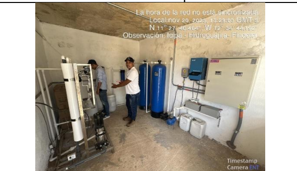
Fotografía 6. Verificación de los componentes del sistema en especial el tanque de almacenamiento de cloro en la comunidad de Icipa.
