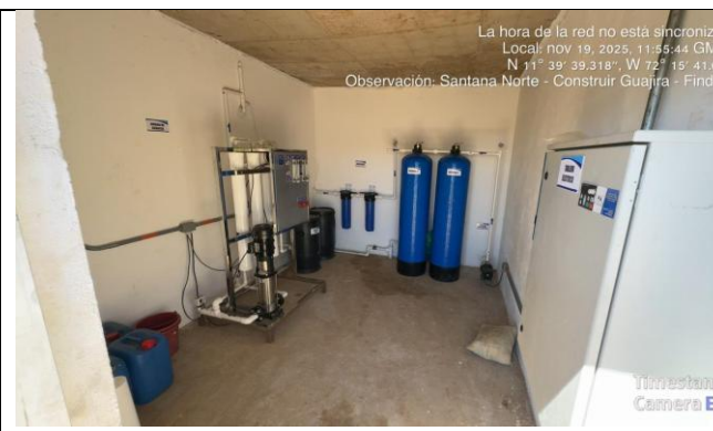
Fotografía 2. Sistema de potabilización de agua en la comunidad de Santana Norte.
