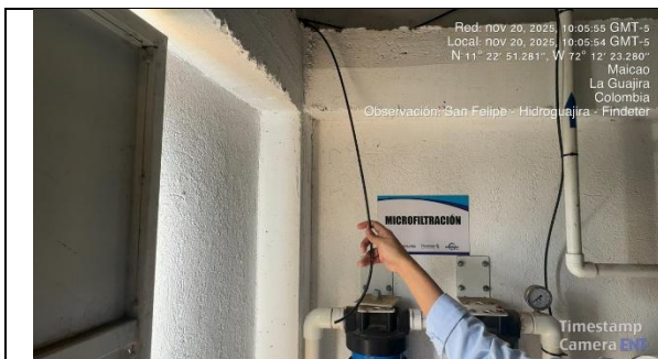
Fotografía 1. Manguera de la dosificadora de cloro rota en la comunidad de San Felipe.
