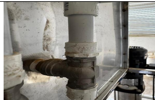
Fotografía 6. Fuga en tubería de osmosis inversa.
