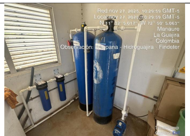
Fotografía 2. Sistema de filtración de la planta potabilizadora en la comunidad de Totopana.
