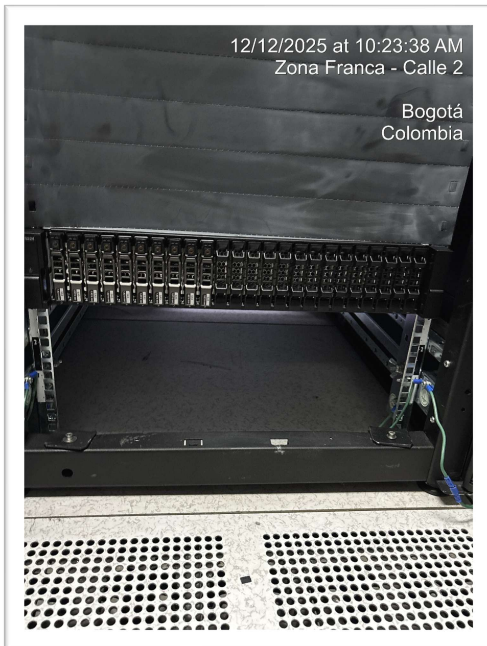
Imagen 3 Instalación rack PowerVault
