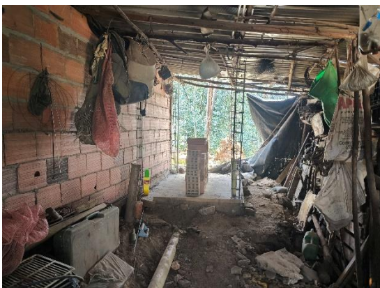
Placa de contrapiso unidad sanitaria
