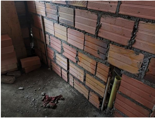
Instalaciones hidráulicas y sanitarias.
