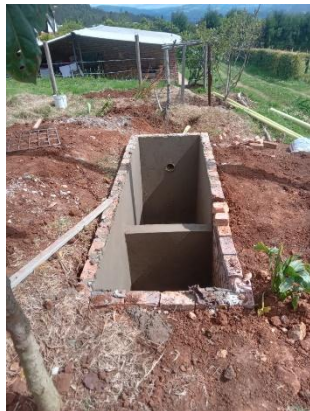
Pañete de pozo séptico
