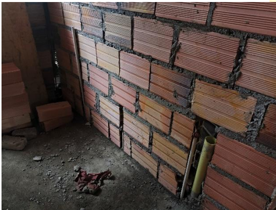
Instalaciones hidráulicas y sanitarias.
