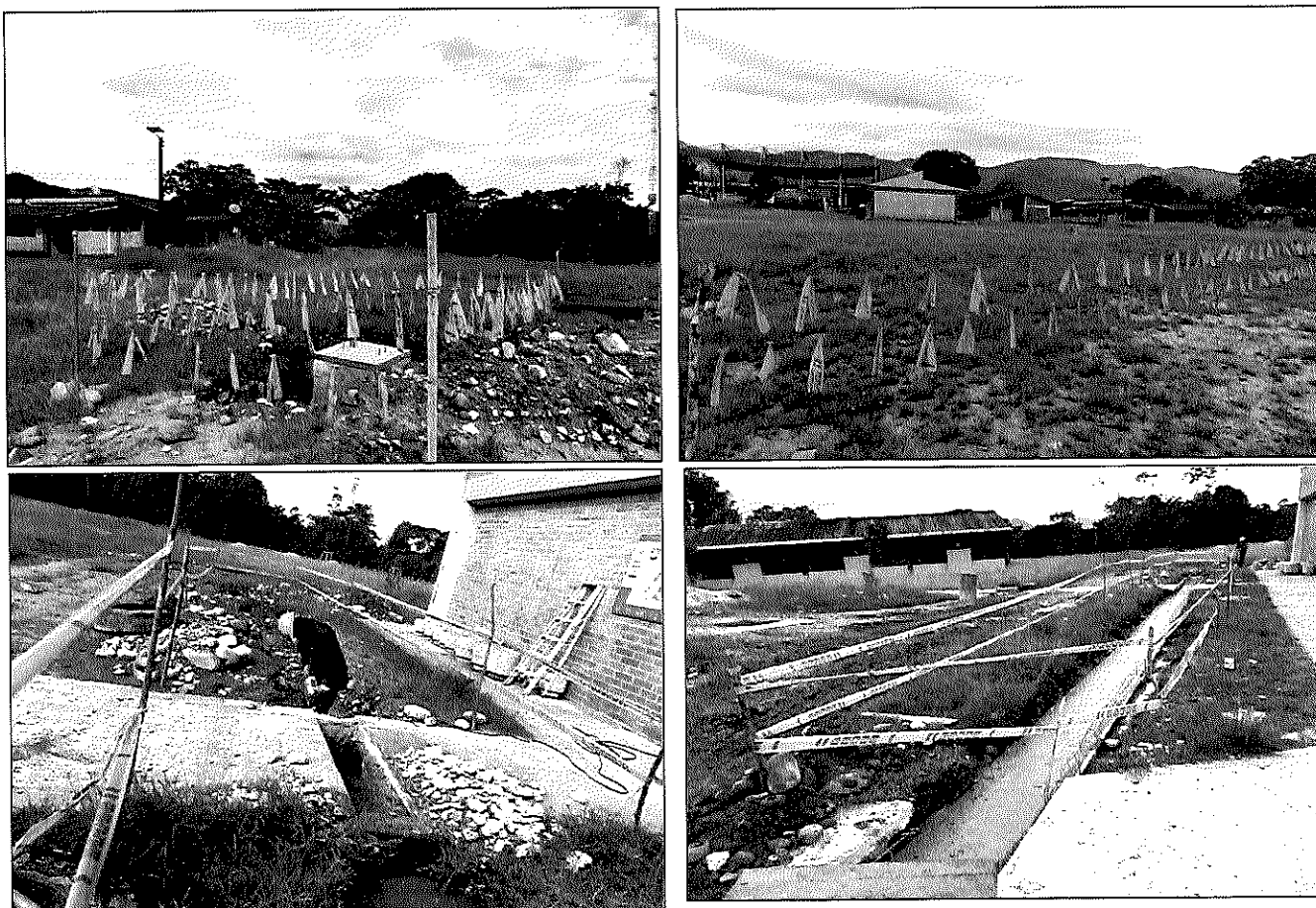
FIGURA 7 SEÑALIZACIÓN AREAS EXTERNAS
