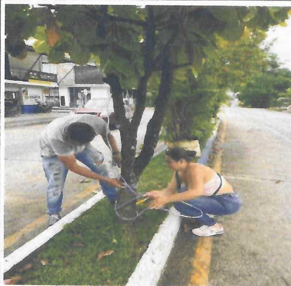
Foto 14: Colocando alumbrado navideño separadores
