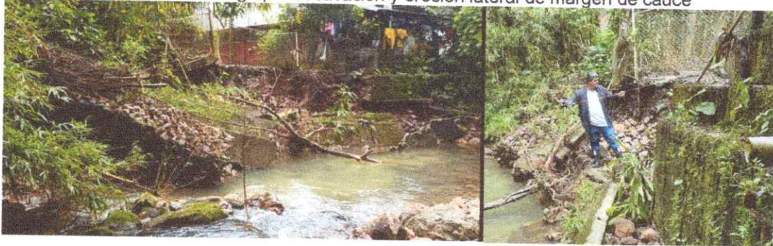
Ilustración 5. Riesgo por socavación y erosión lateral de margen de cauce
