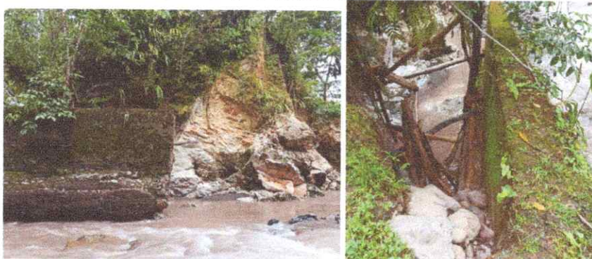
Ilustración 11 Socavón y se paramiento del muro de contención
