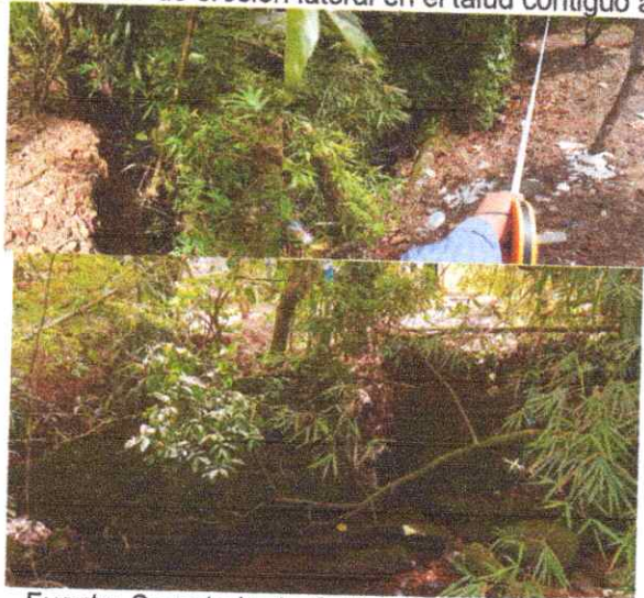
Ilustración 5. Proceso de erosión lateral en el talud contiguo a la vivienda
