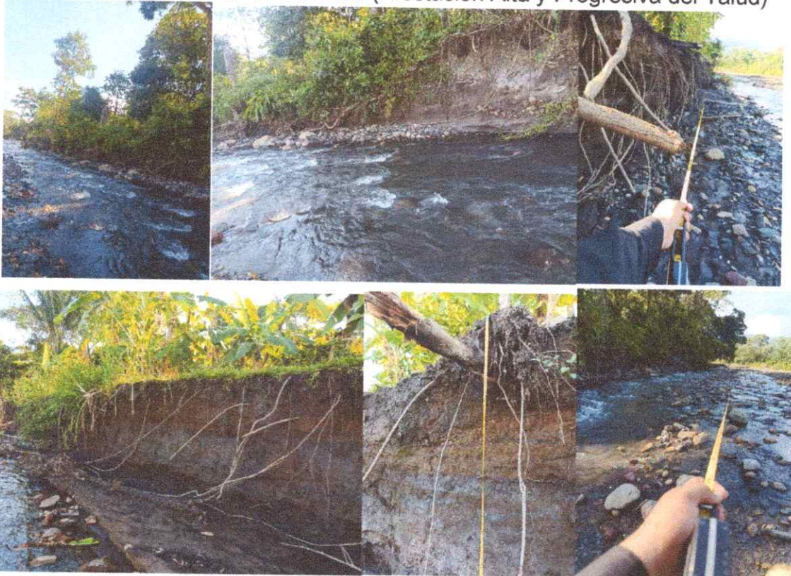
Ilustración 6 Tramo de 136 metros (Afectación Alta y Progresiva del Talud)
