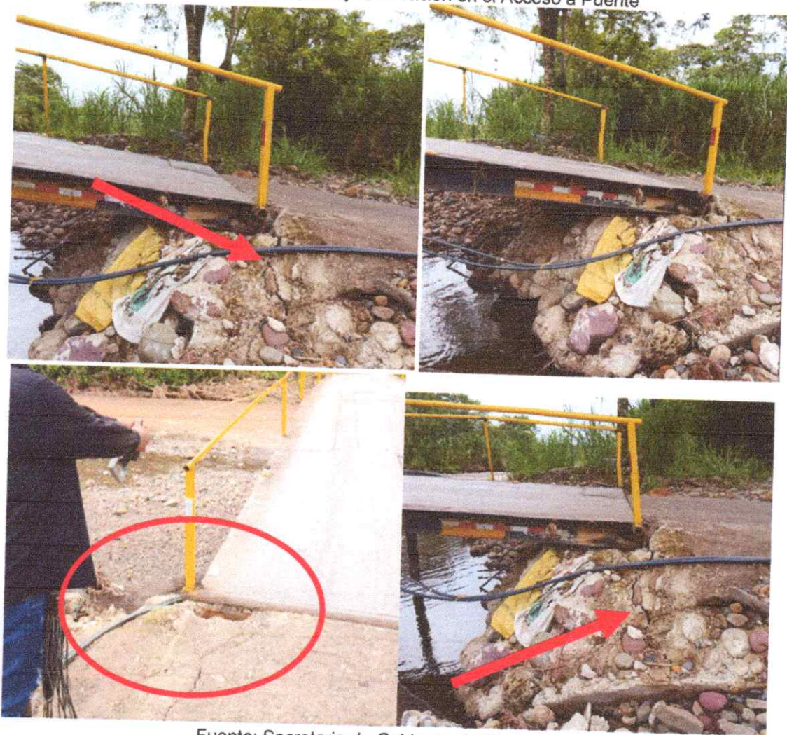
Ilustración 5. Erosión y Socavación en el Acceso a Puente
