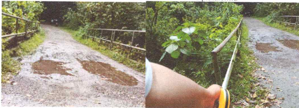
Ilustración 15 Deterioro avanzado de la plataforma
