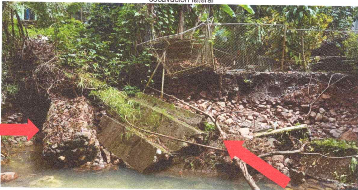
Ilustración 6. Remoción en masa por deslizamiento y caída de material pétreo, inducida por socavación lateral
