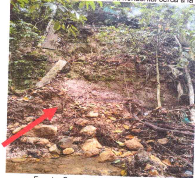
Ilustración 6. Erosión en talud horizontal cerca a la vivienda
