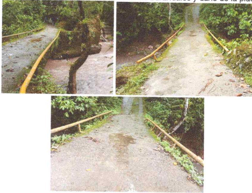
Ilustración 12 Deformación Estructural de Barandales y daño de la placa
