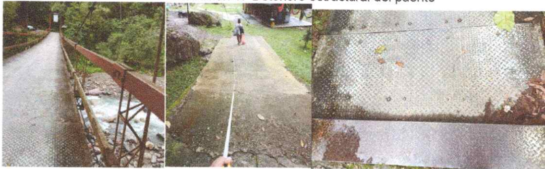
Ilustración 17 Deterioro estructural del puente
