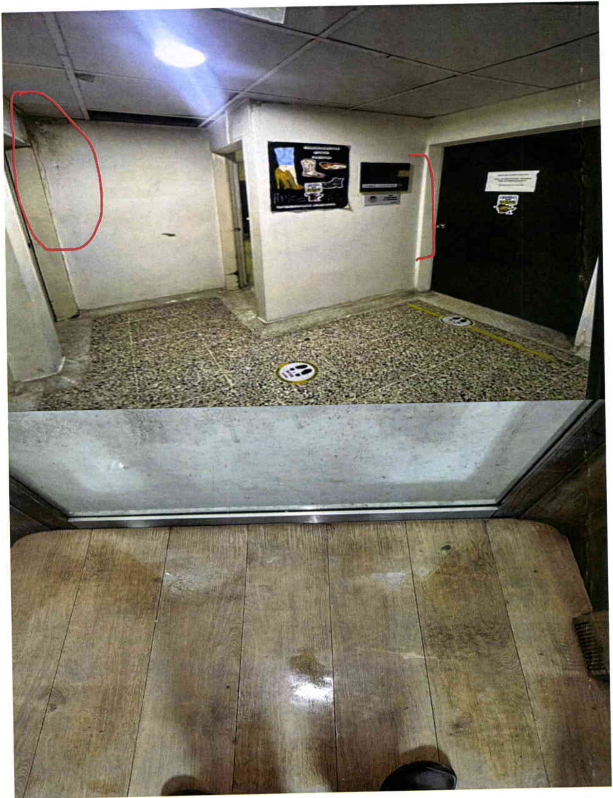
Piso y sobrepiso en madera laminado averiado (soplado) y despegado por exceso de agua estancada.
