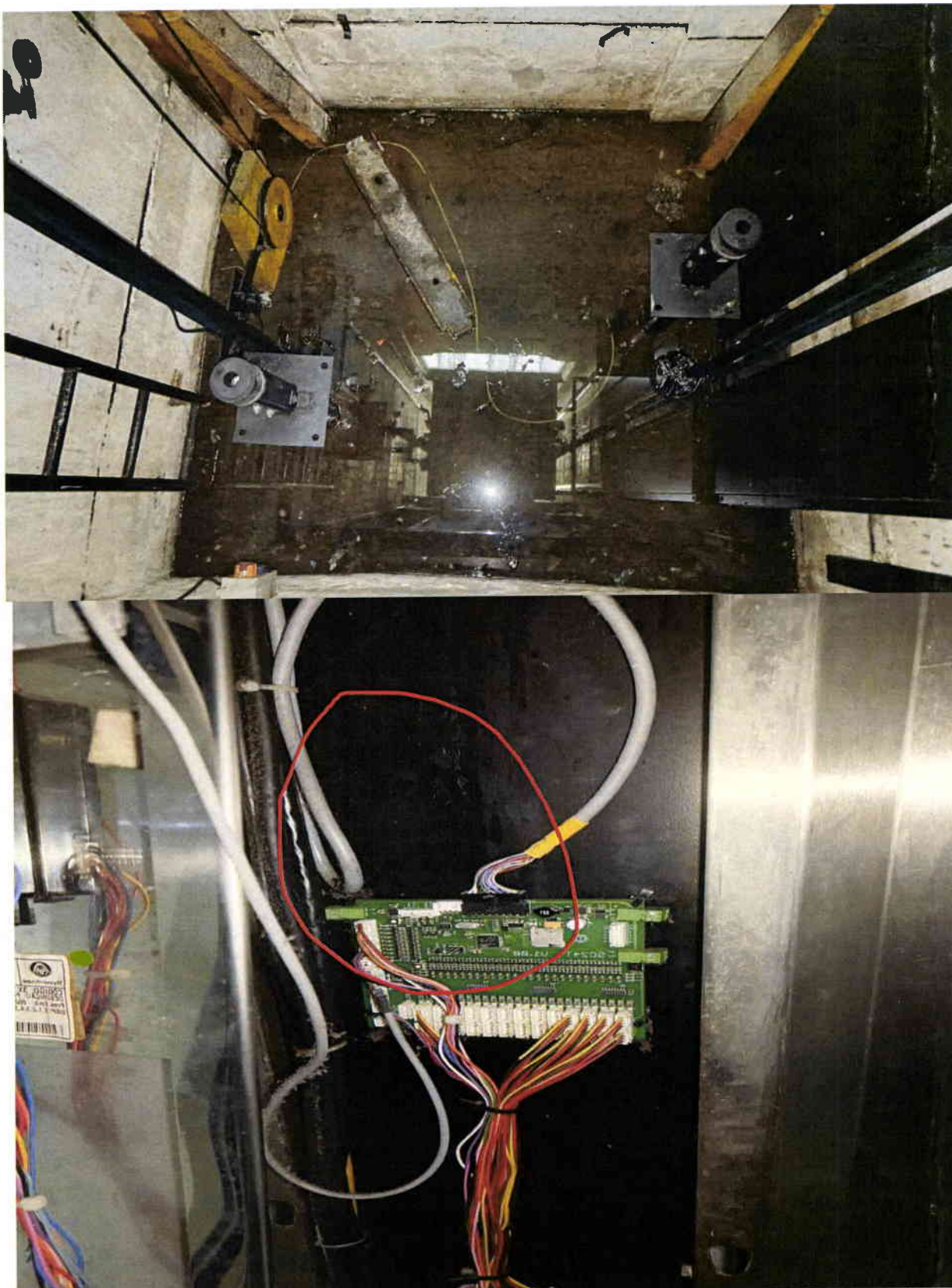
Evidencia de Cabina mojada y húmeda en todas sus caras y foso con una lámina de agua estancada.
