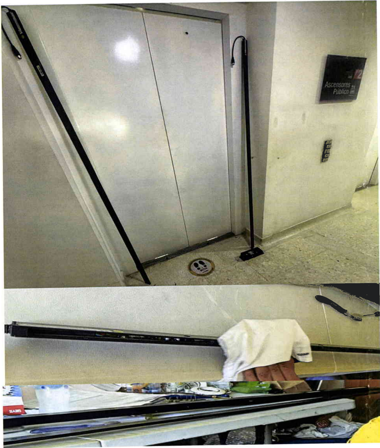
Cortina electrónica (Fotocelda de rayos x) averiada por daño en el sensor.
