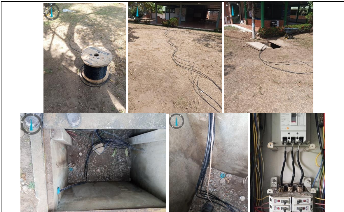
Reg. Fot. No. 15, Acometida subterránea en cable de cobre aislado 4x4+1x6T AWG THHN/THWN-2 600 V 90°C
