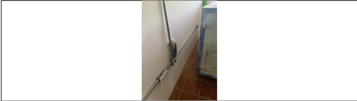
Reg. Fot. No. 17, Salida para tomacorriente a 220 V, 30 A, en tubo EMT tipo pesado 3/4"y cable de cobre.
