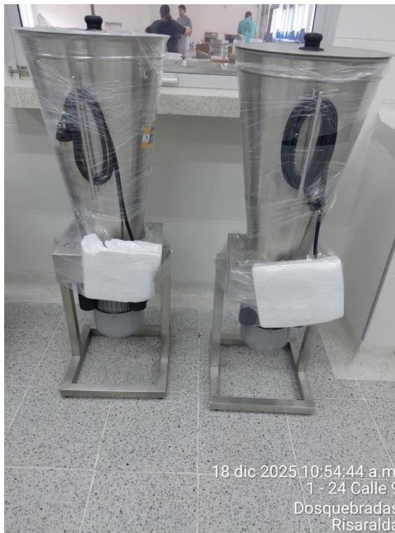
Ilustración 9 licuadoas industriales 2 unidades
