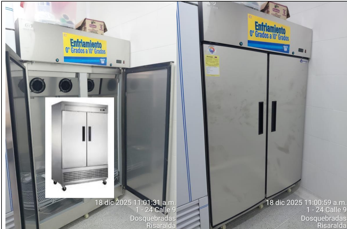
Ilustración 15 cava de refrigeración
