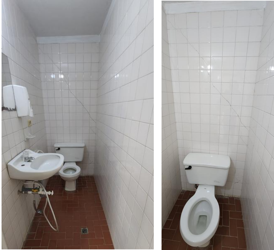
Ilustración 4. Enchapes de baños fracturados
