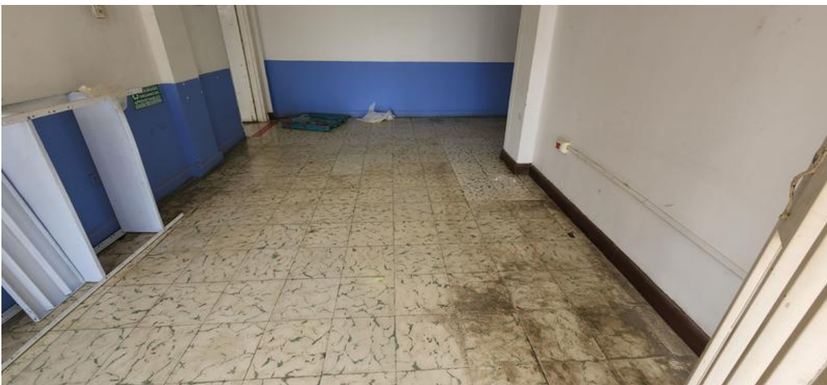
Ilustración 5. Humedades en Pisos y Paredes
