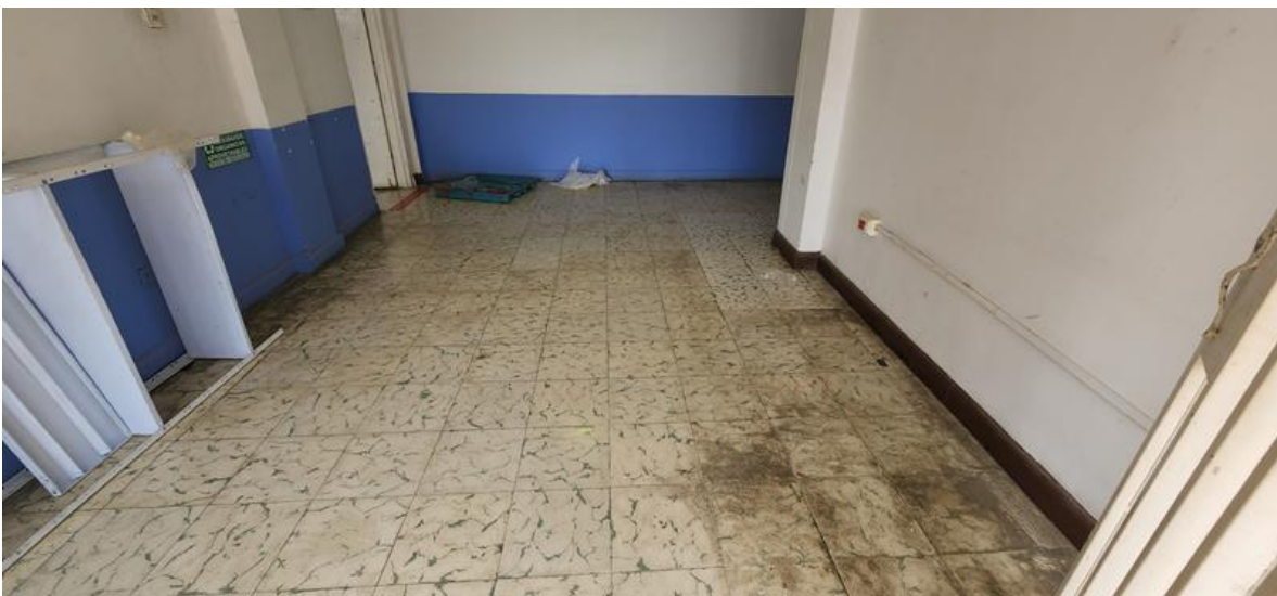
Ilustración 5. Humedades en Pisos y Paredes
