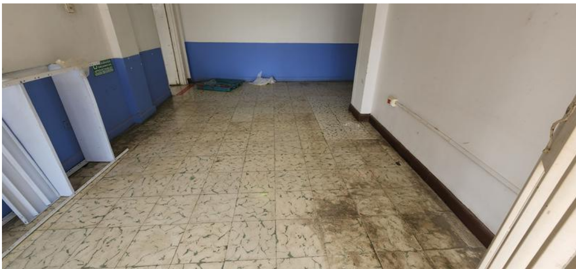
Ilustración 5. Humedades en Pisos y Paredes
