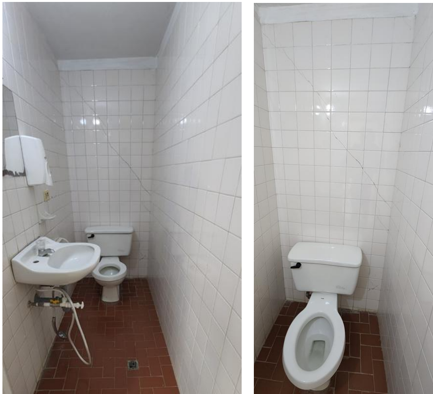
Ilustración 4. Enchapes de baños fracturados
