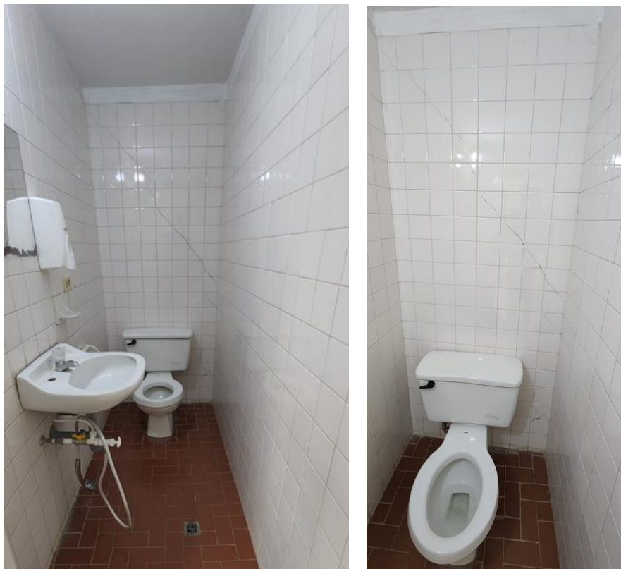
Ilustración 4. Enchapes de baños fracturados
