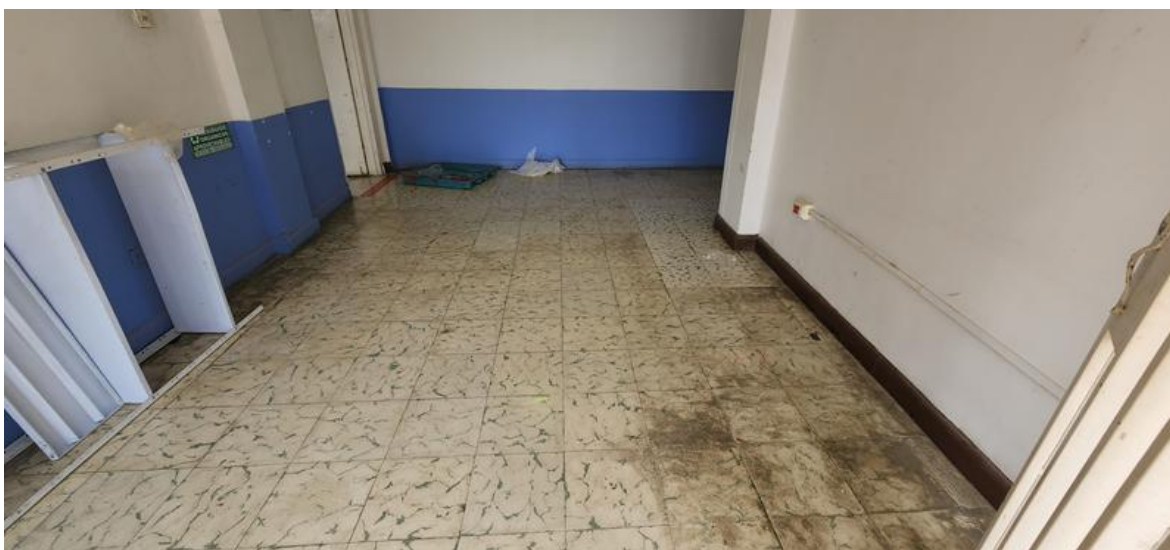
Ilustración 5. Humedades en Pisos y Paredes
