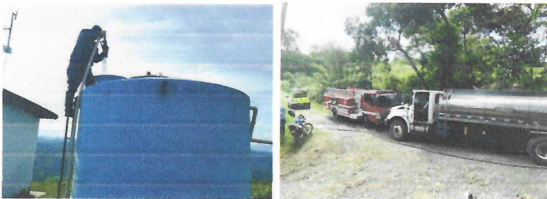
Septiembre 16 – 2025. Se brindo apoyo en el traslado de agua para los tanques de la empresa de servicios público en la vereda Pedregal en donde por medio de las bombas especializadas a 170 PSI se Bombeo agua en apoyo del carrotanque de la CAS.
