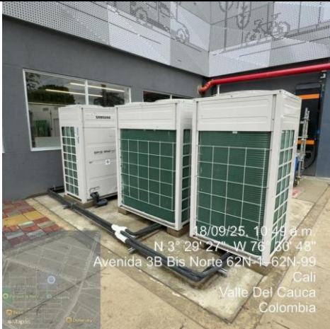
Unidad de climatización
