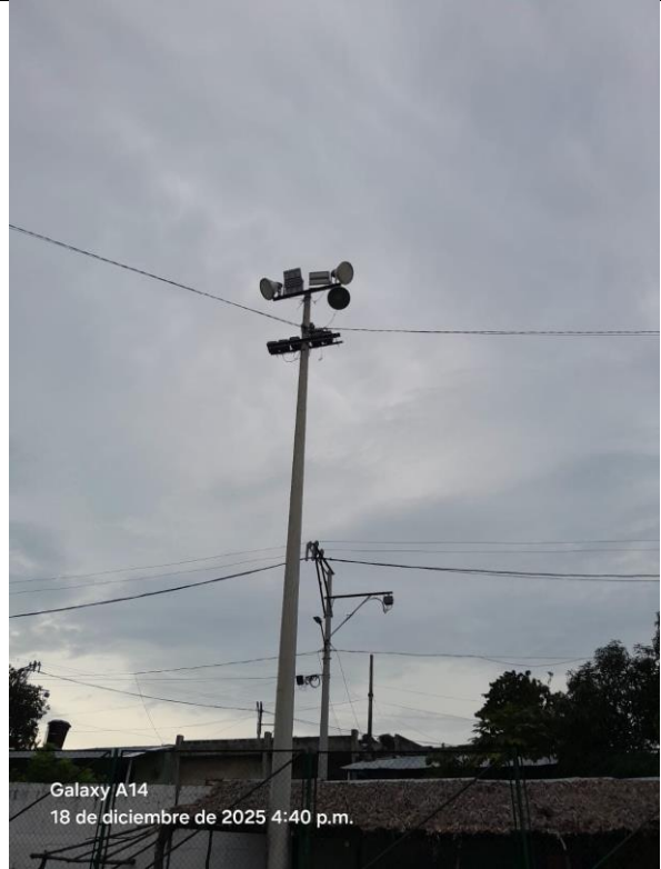
Foto 2. Vista de torre/poste con luminarias instaladas: Reflector 2. (18/12/2025).
