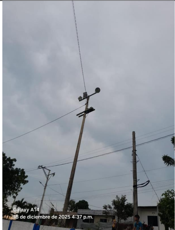
Foto 4. Vista complementaria de poste y luminarias: Reflector 4. (18/12/2025).
