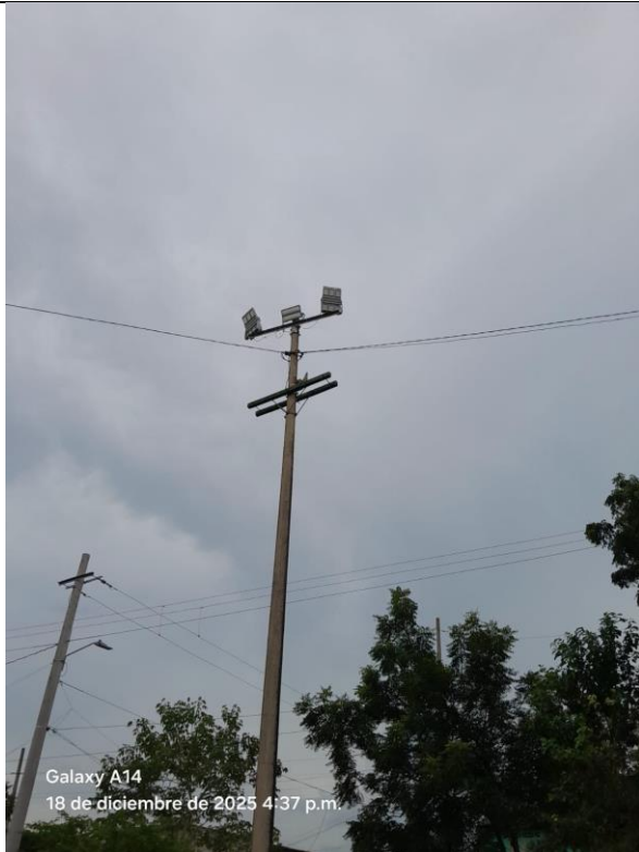
Foto 3. Evidencia de luminarias instaladas: Reflector 3. (18/12/2025).
