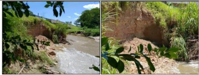
Figura No.2: Panorámica del estado actual del Talud externo de la vía
