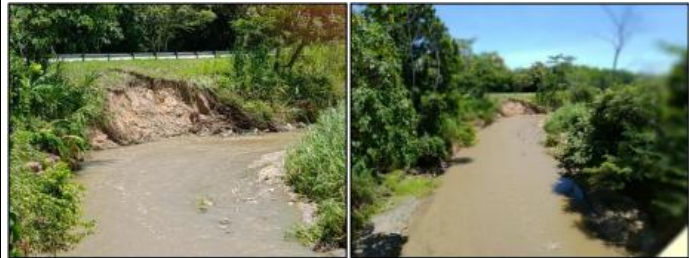
Figura No.1: Panorámica del estado actual del Talud externo de la vía
