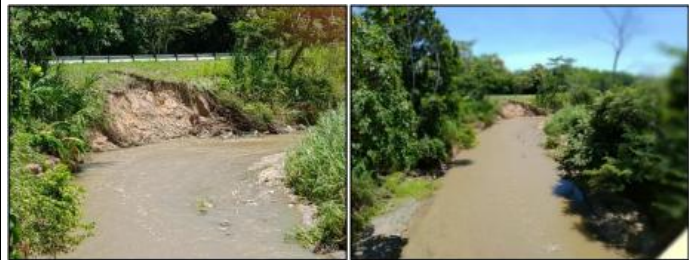
Figura No.1: Panorámica del estado actual del Talud externo de la vía
