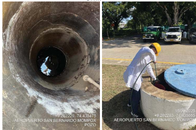
Imagen 2. Pozo del Aeropuerto San Bernardo de Mompox - Unidad Administrativa Especial de Aeronáutica Civil.
