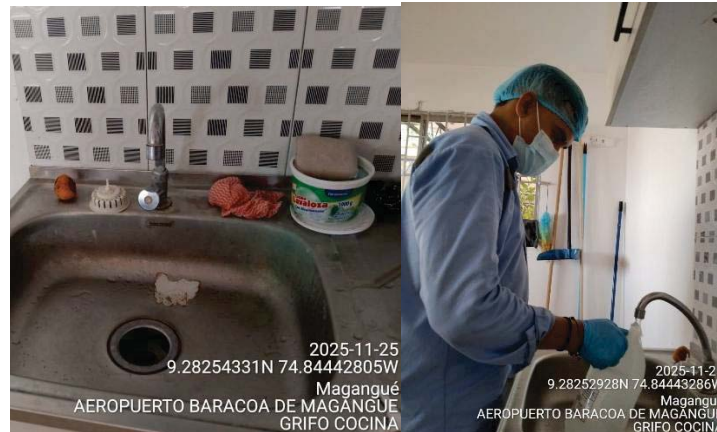
Imagen 2. Grifo Cocina del Aeropuerto Baracoa de Magangué - Unidad Administrativa Especial de Aeronáutica Civil.
