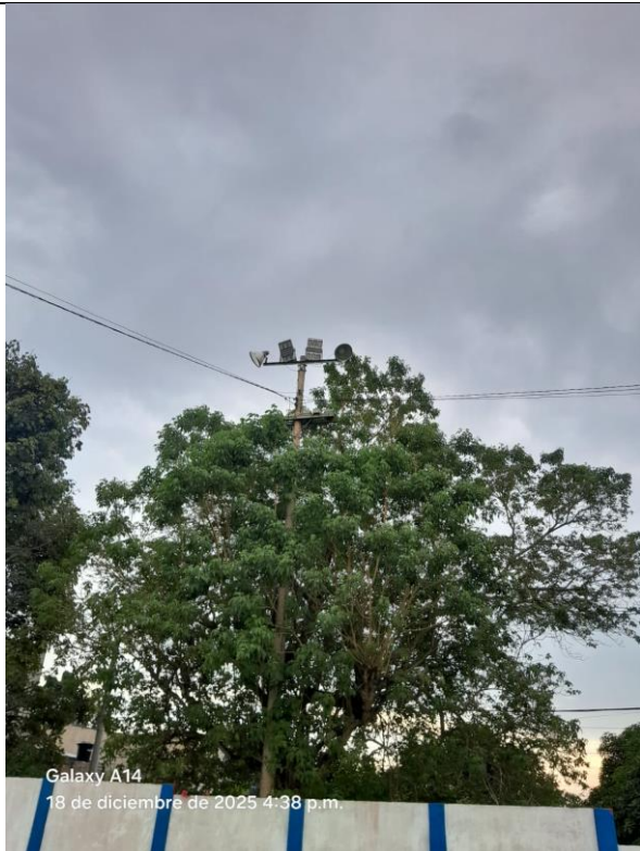
Foto 5. Poste donde no se instaló reflector led de 600W (18/12/2025).
