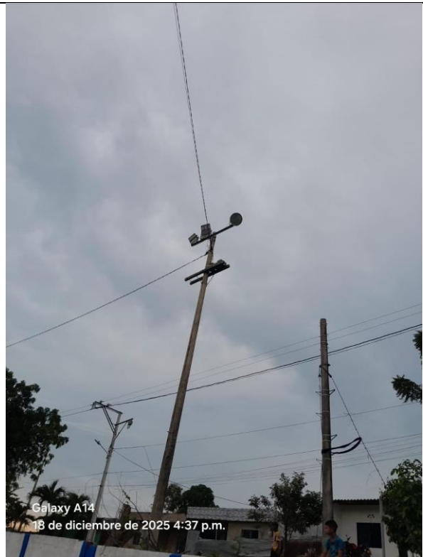
Foto 4. Vista complementaria de poste y luminarias: Reflector 4. (18/12/2025).
