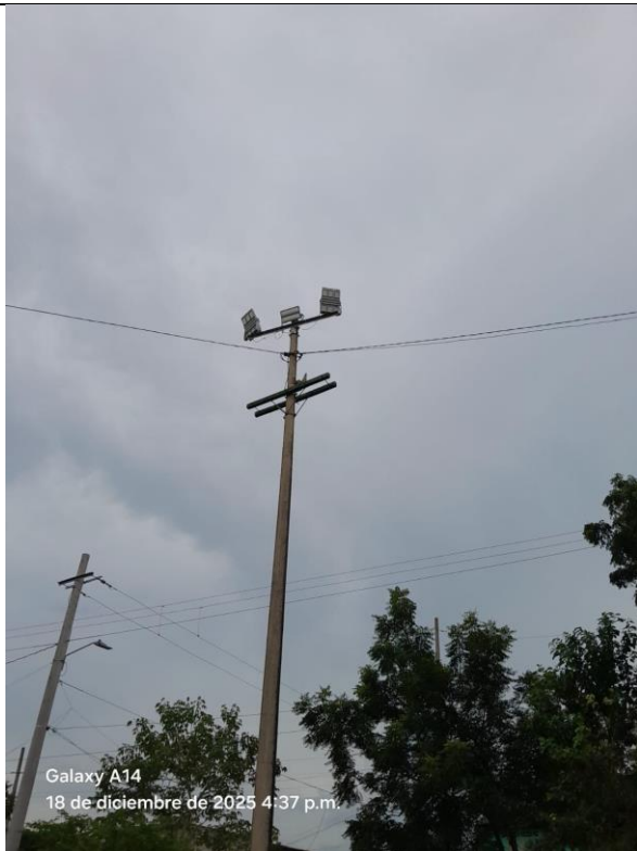
Foto 3. Evidencia de luminarias instaladas: Reflector 3. (18/12/2025).
