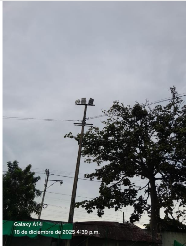
Foto 6. Vista de torre/poste con luminarias instaladas: Reflector 5. (18/12/2025).
