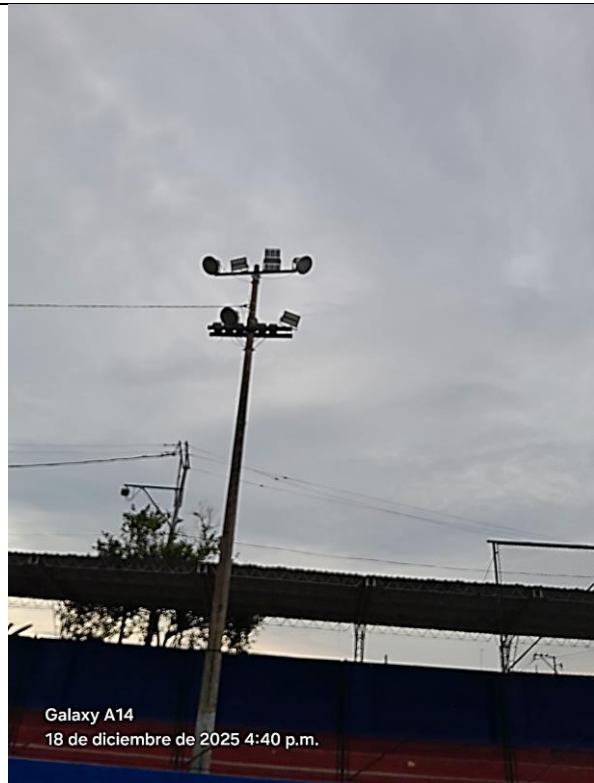
Foto 8. Vista complementaria de poste y luminarias: Reflector 7 y 8. (18/12/2025).
