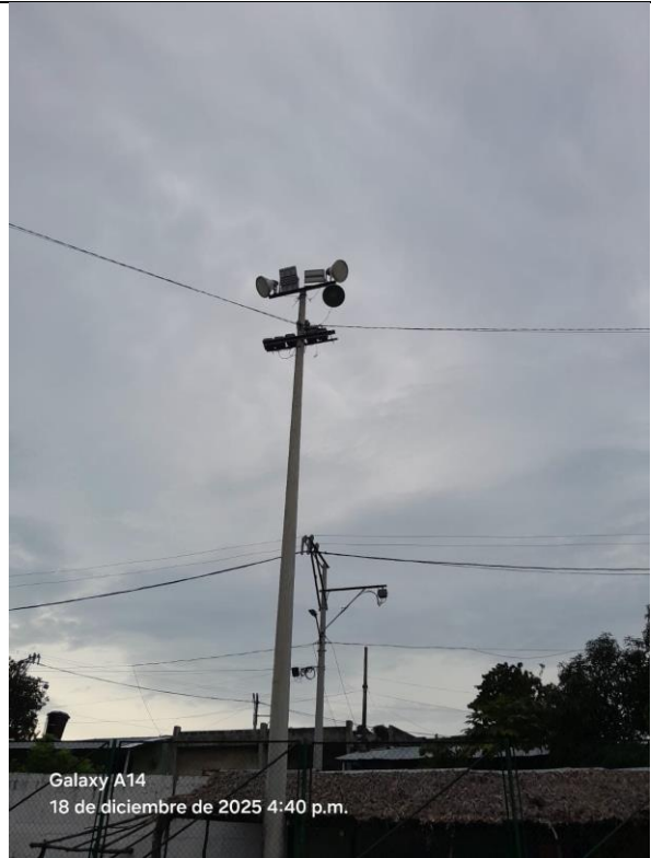
Foto 2. Vista de torre/poste con luminarias instaladas: Reflector 2. (18/12/2025).
