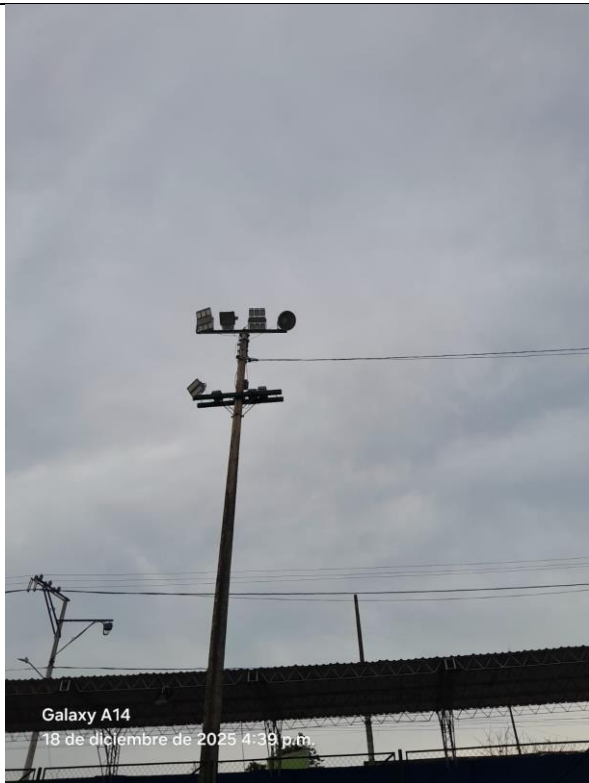
Foto 7. Evidencia de luminarias instaladas: Reflector 6. (18/12/2025).
