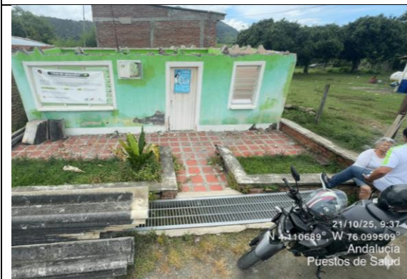
Sistema de drenaje con rejilla y canal
