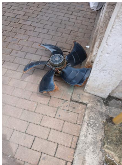
Mantenimiento Motores Condensadoras
