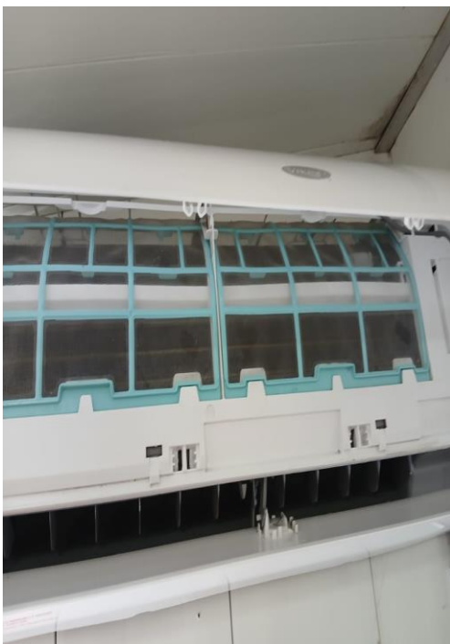
Lavado de Filtros
