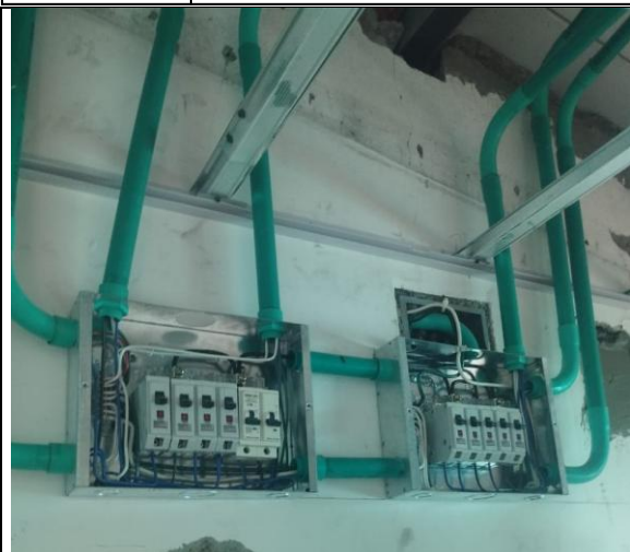
Sistema eléctrico, cables, breakers, tableros, tuberías
