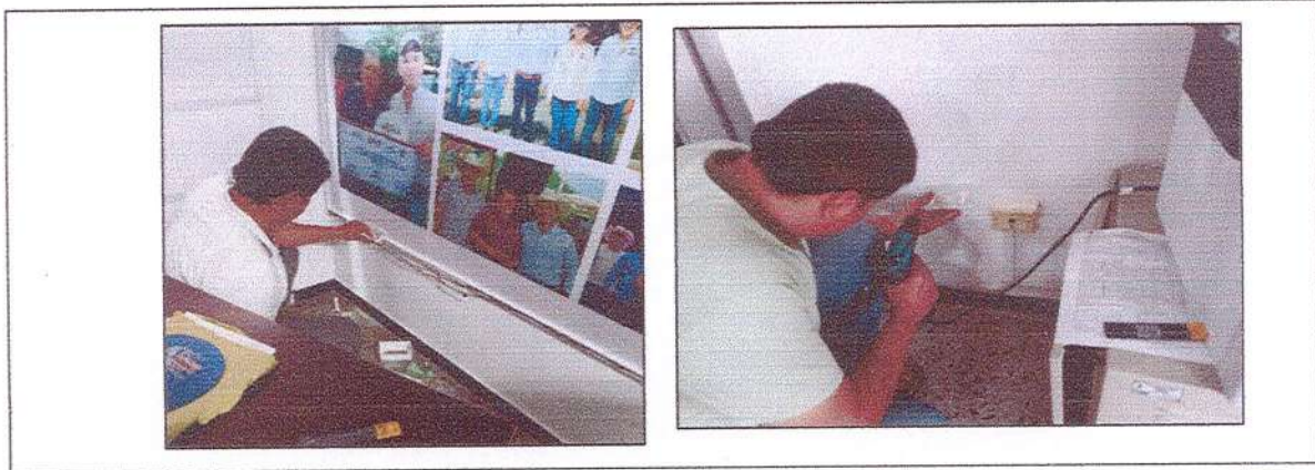
ITEM 6.3 TABLERO DE 12 CIRCUITOS-INCLUYE INSTALACION
