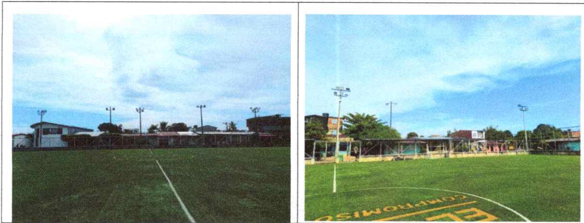
Fotografía 1, 2, 3 y 4. Luminarias a ser removidas.
