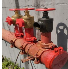
VÁLVULAS ANGULARES SUMINISTRADAS, INSTALADAS EN CABEZAL
