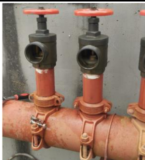
VALVULAS ANGULARES EXISTENTES
