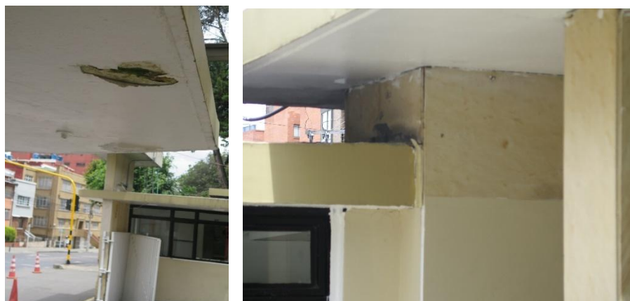
Figura 24. Patología guardia principal. Fuente: toma fotográfica propia
