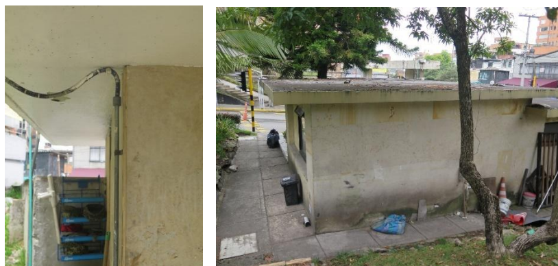
Figura 26. Patología guardia principal. Fuente: toma fotográfica propia
