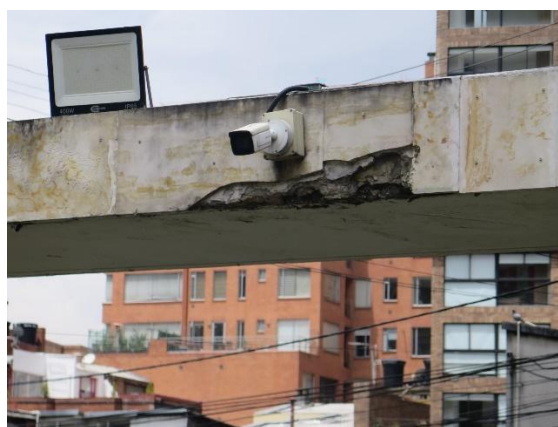
Figura 23. Patología guardia principal. Fuente: toma fotográfica propia
