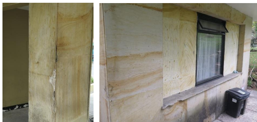
Figura 25. Patología guardia principal. Fuente: toma fotográfica propia
