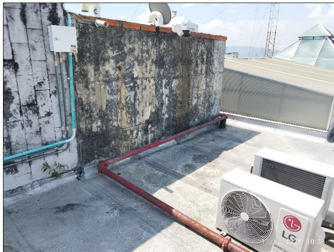
Imagen 5. Tubería AC oxidada, anclada a piso que alimenta a gabinetes
