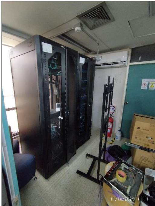
Imagen 9. Detector de humo con caja obsoleta
