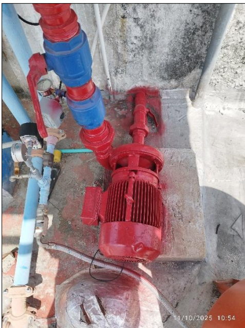
Imagen 1. Sistema de bombeo centrifugo para red de agua
