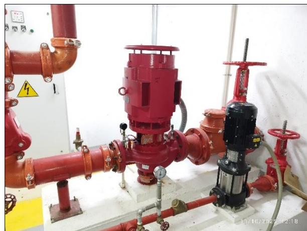
Imagen 12. Equipo de bombeo contra incendios, marca aurora de 500GPM@103PSI existente del edificio contiguo del SENA.
