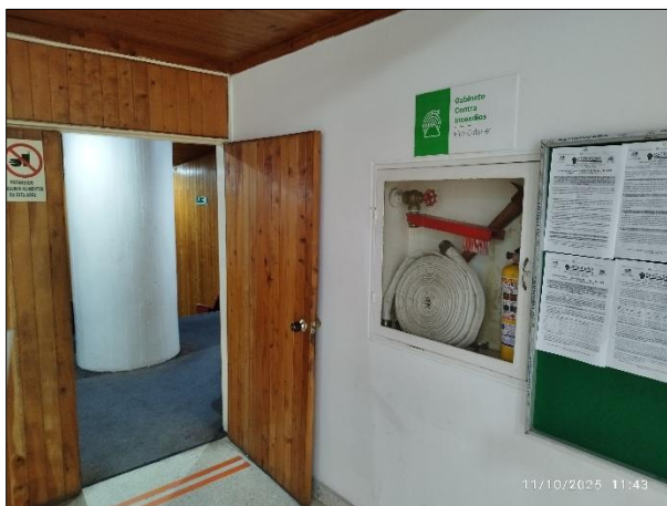
Imagen 11. Gabinete contra incendios Clase II, acceso a auditorio
