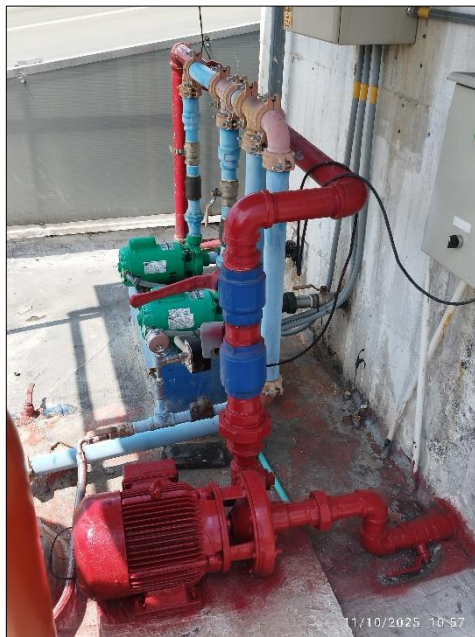
Imagen 2. Sistema de bombeo dual de agua
