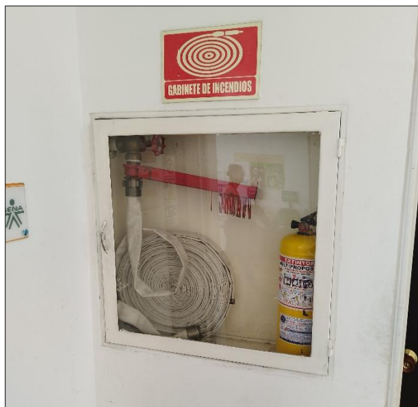
Imagen 7. Gabinete contra incendios Clase II, en punto fijo
