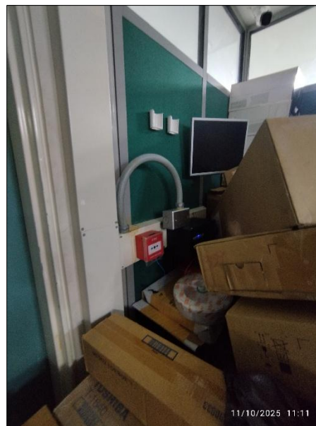
Imagen 8. Estación manual obsoleta
