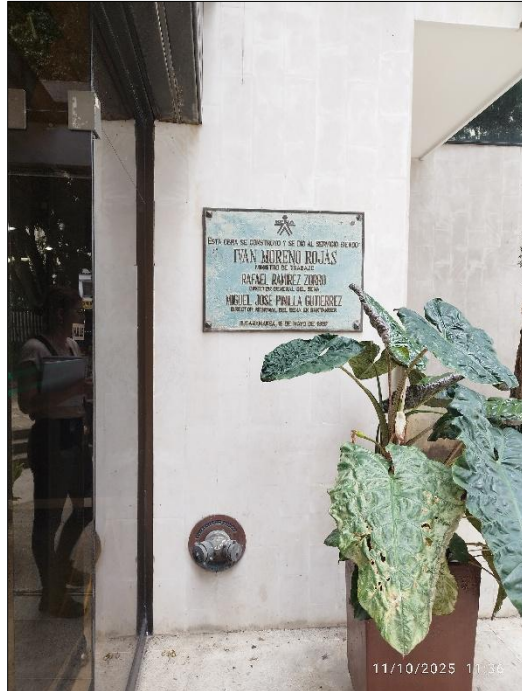
Imagen 10. Conexión a bomberos en borce de Ø4 con salida de Ø2 ½"
