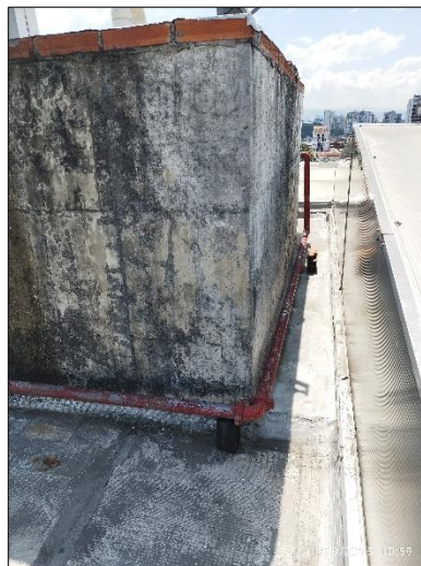
Imagen 6. Salida Tubería AC de tanque de almacenamiento, que alimenta a gabinetes
