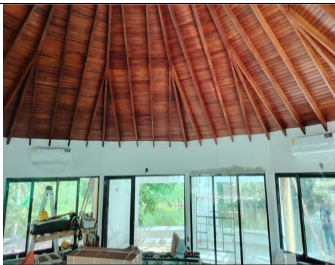
Fuente: Equipo Supervisión Foto No.16: Frente CAMOF – BRIM1 Descripción: Acabados obra blanca.
