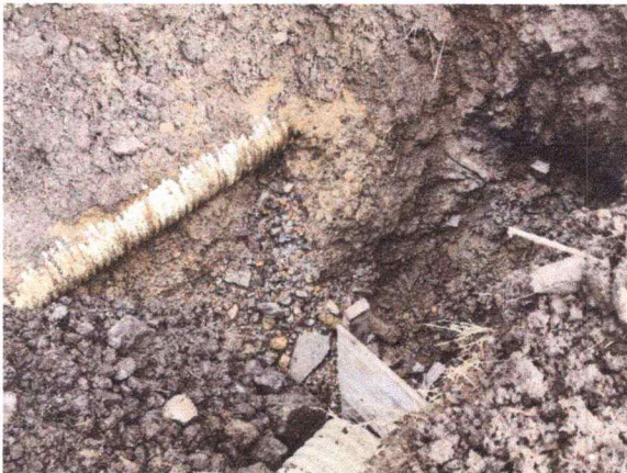
6. Excavación de material común en condiciones de nivel freático elevado y presencia significativa de surgencias de agua.
