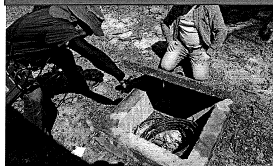
VERIFICACIÓN DE CABLEADO PARA
