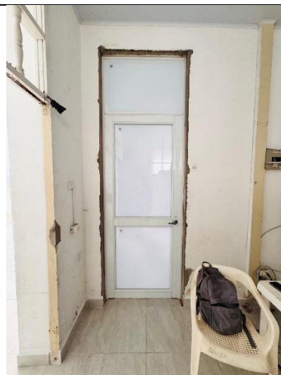
Ilustración 6: Resanes en marcos de puertas
