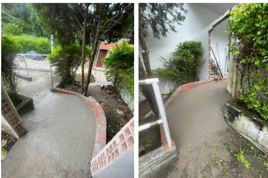
Foto 1. Necesidad de baranda metálica y gravilla lavada
