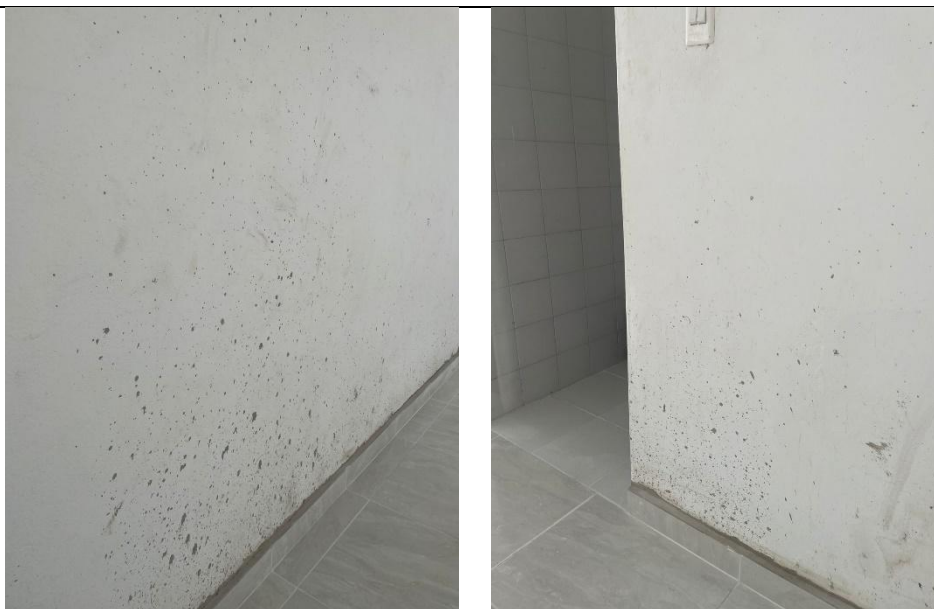
Foto 2: Áreas con necesidad de Pintura general
