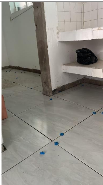
Foto 4: Necesidad de Instalación de guarda escoba en PVC zona de vacunación y pre consulta
