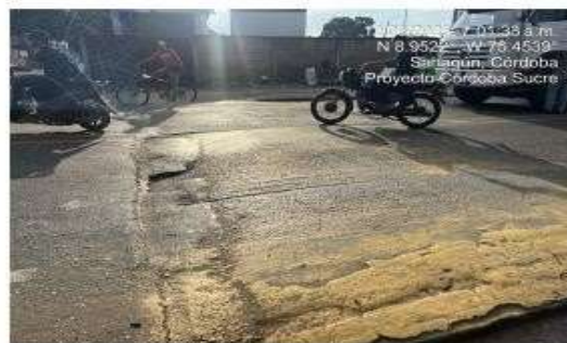
Resalta en mal estado con baches y hundimiento en zona de aproximación.
