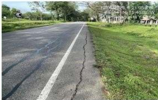
Fisuras y grietas longitudinales en calzada y de borde en berma
