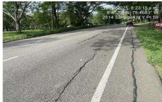
Fisuras y grietas longitudinales en calzada y de borde en berma reincidentes
