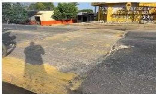
Resalta en mal estado con baches y hundimiento en zona de aproximación.
