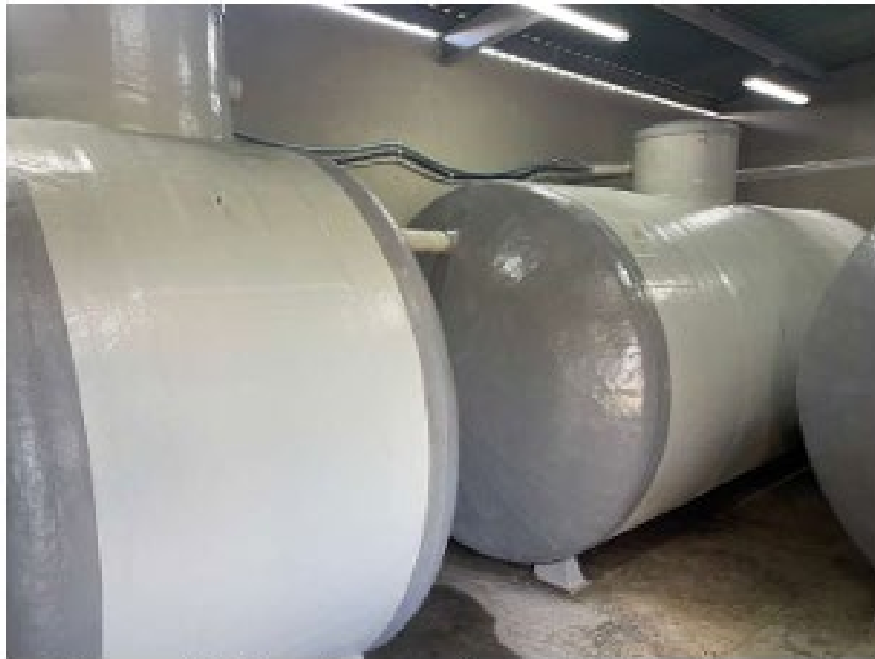
Imagen 41. Planta de tratamiento aseada y operando
