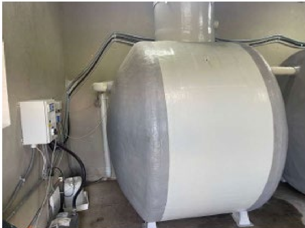
Imagen 42. Planta de tratamiento aseada y operando
