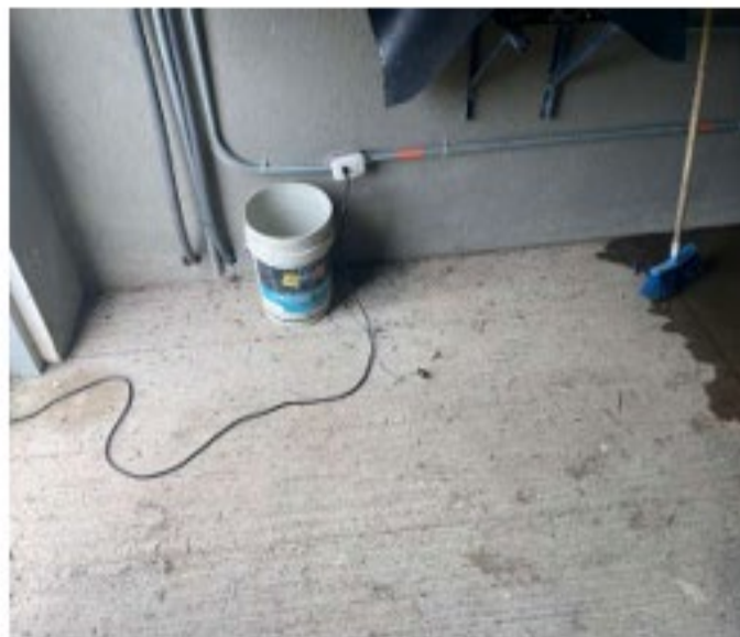
Imagen 1 A 3. Estado de tanques y equipos antes del mantenimiento
