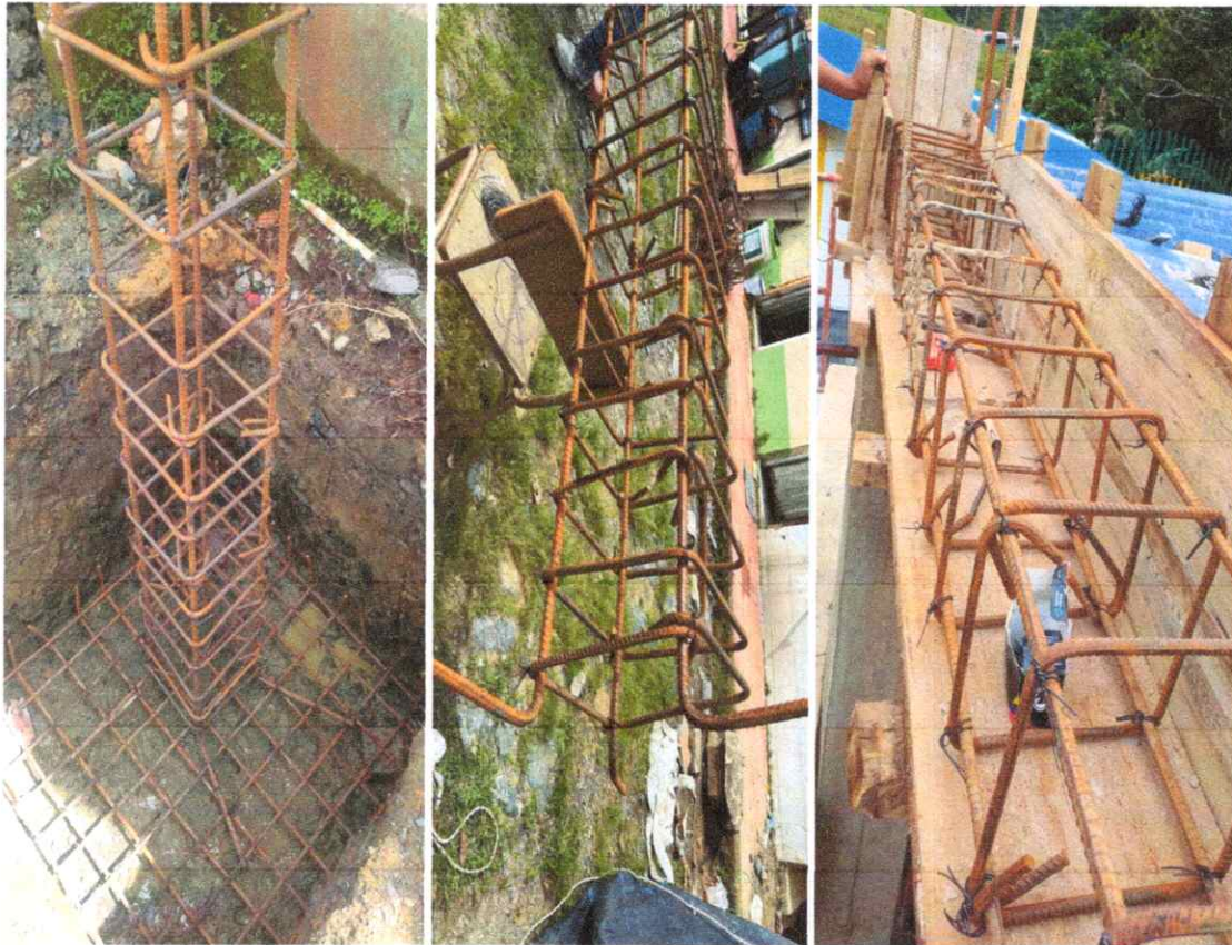
Foto 39, 40 y 41. Suministro, figurado y amarre de acero para las zapatas, columnas, viga y placa para tanques de reserva de agua.
