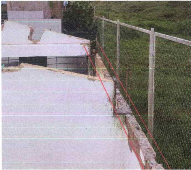
Foto 6. Retiro y demolición de viga aérea en concreto, garantizando la disposición adecuada del material demolido.
