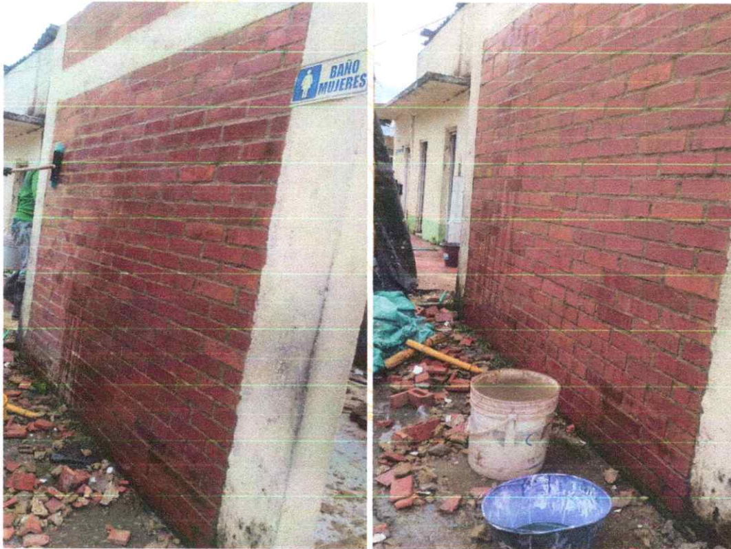
Foto 9. Lavado de la fachada en muros utilizando ácido muriático para mejorar el acabado y eliminar el barniz antiguo y la suciedad acumulada.
