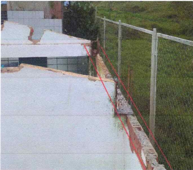
Foto 6. Retiro y demolición de viga aérea en concreto, garantizando la disposición adecuada del material demolido.
