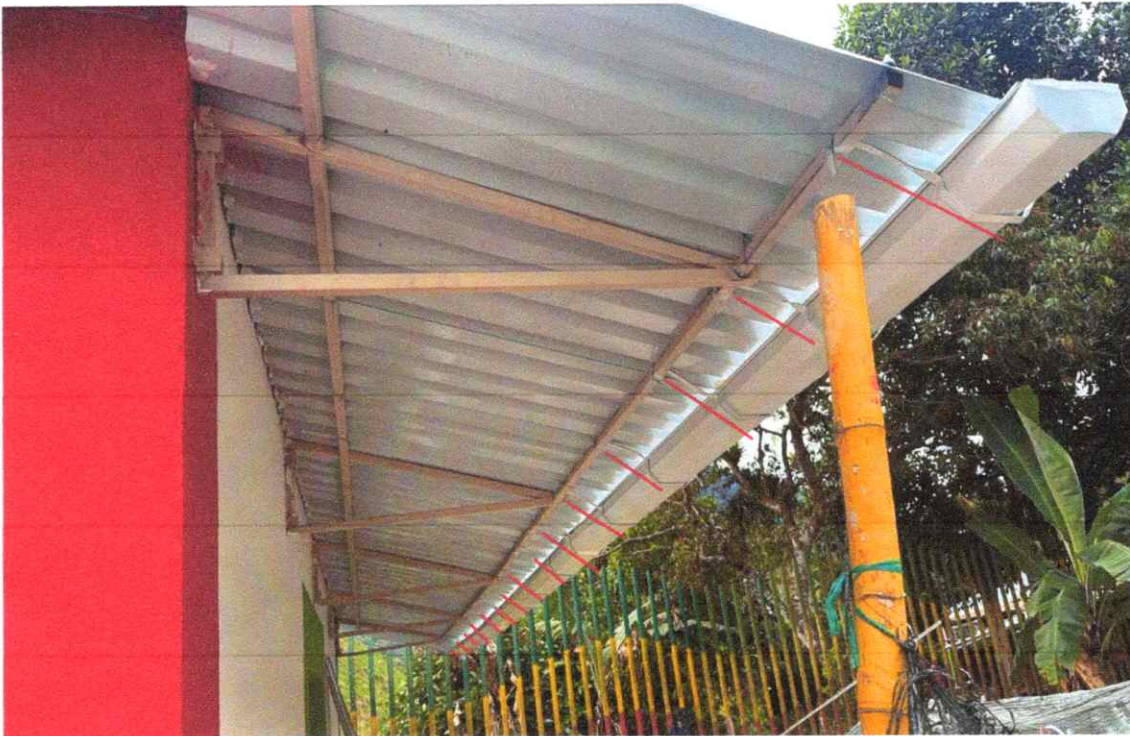
Foto 49. Instalación de soportes metálicos para el sistema de canal de aguas lluvias, incorporando labores de soldadura y aplicación de pintura protectora.
