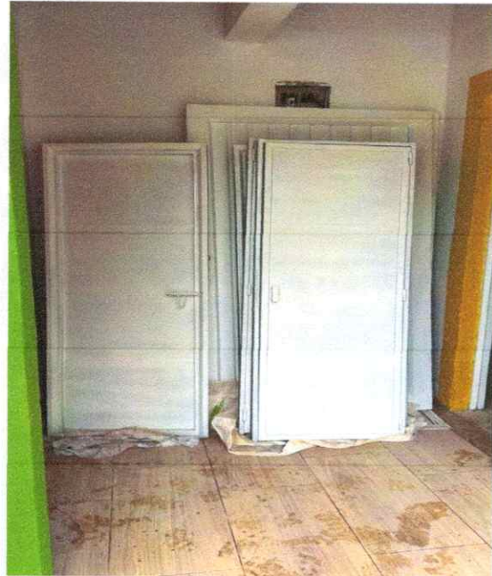
Foto 18. Aplicación de tres manos de esmalte sobre lámina llena, con el propósito de mejorar la apariencia y proteger el material frente a la corrosión.
