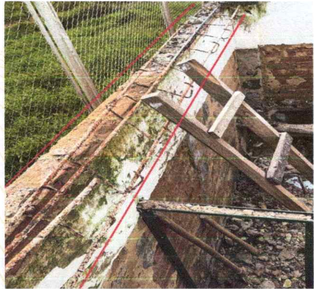
Foto 7. Retiro y demolición de viga aérea en concreto, garantizando la disposición adecuada del material demolido.
