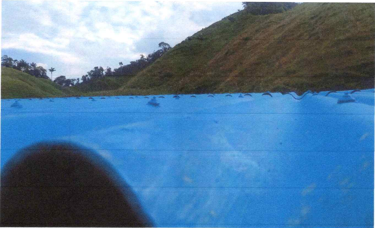
Foto 20. Pintura de alta resistencia al desgaste y antideslizante en tres manos, con el fin de proporcionar una superficie duradera, segura y con acabado uniforme.
